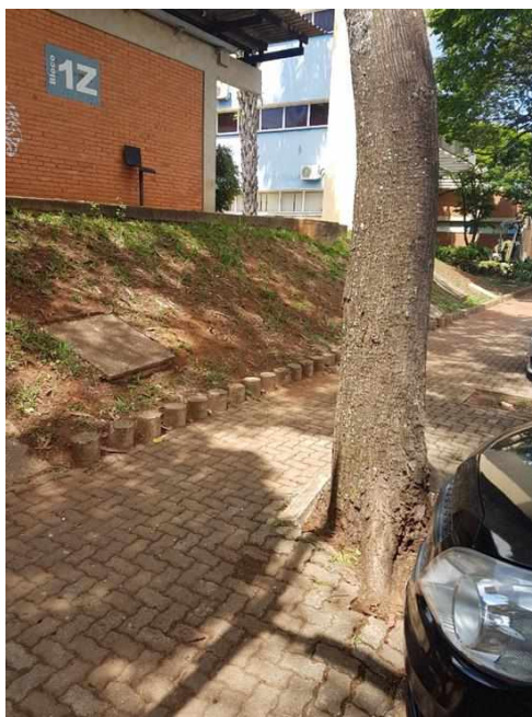
Figura 19 – Passeio mal dimensionado - Bloco 1Z
