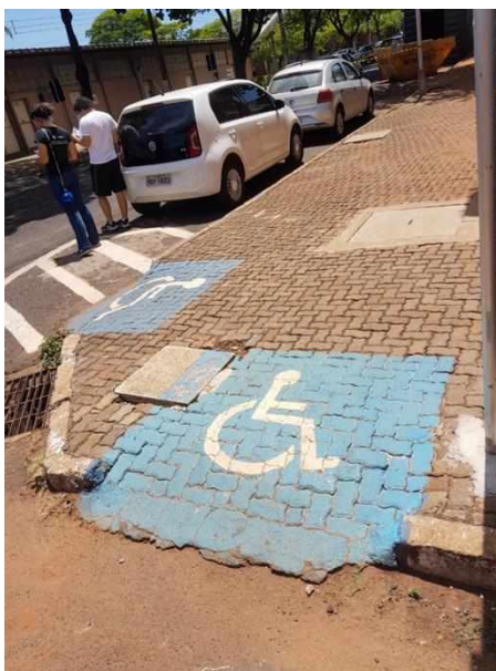
Figura 24 – Rampa deteriorada – Bloco 1M
