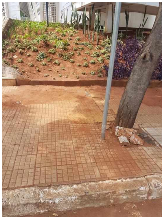
Figura 15 – Irregularidades na calçada do Centro Esportivo
