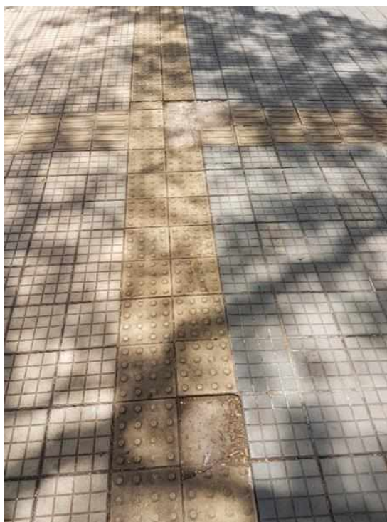
Figura 30 – Piso tátil deteriorado
