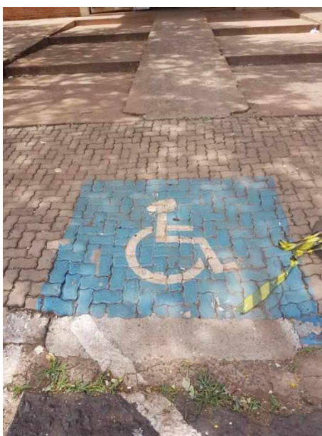
Figura 21 – Rampa de acesso Bloco 1C fora de conformidade
