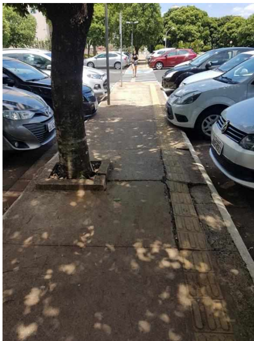
Figura 29 - Faixas destinadas aos deficientes visuais deterioradas – próximo à Reitoria
