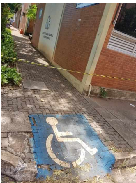
Figura 27 – Rampa fora de norma técnica – Bloco 1D
