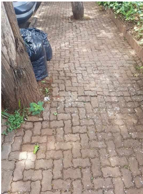
Figura 18 – Passeio mal dimensionado, com elevações - Bloco 1K
