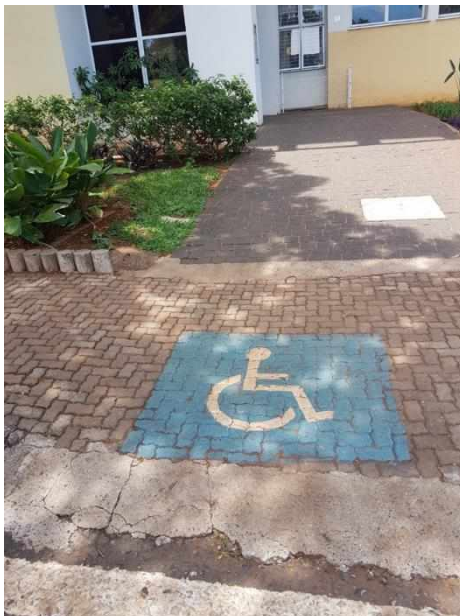
Figura 20 – Rampa de acesso com início deteriorado – Laboratório LTAD
