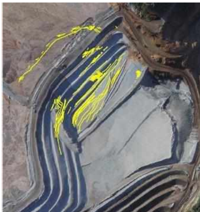
Figura 25: Rachaduras na ombreira esquerda em 2014.
