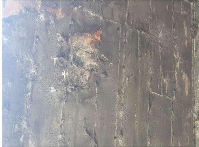
Figura 36 - Eflorescência, carbonatação, deslocamento com exposição e corrosão dos estribos na face inferior do tabuleiro
