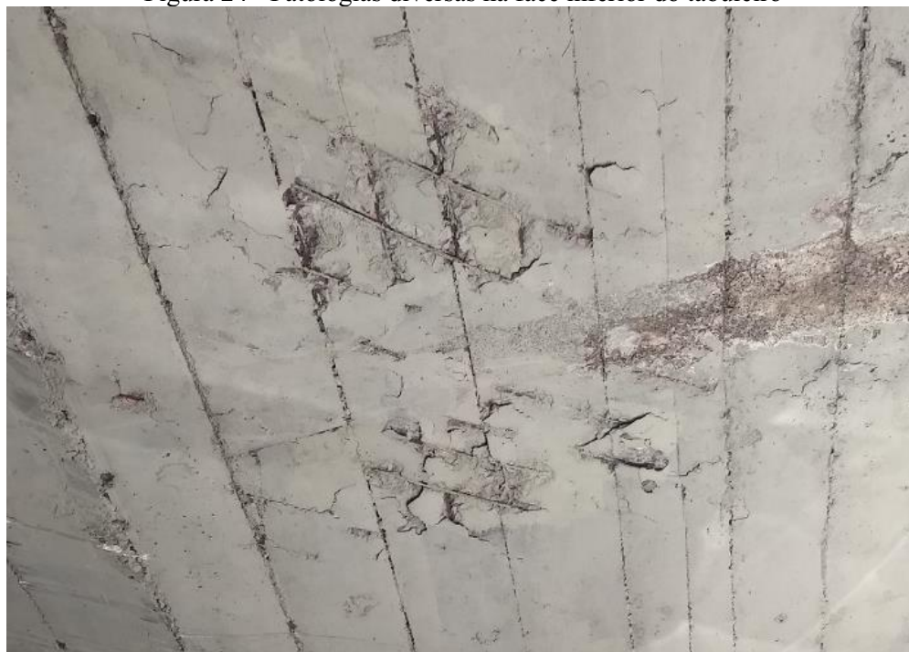
Figura 24 - Patologias diversas na face inferior do tabuleiro
