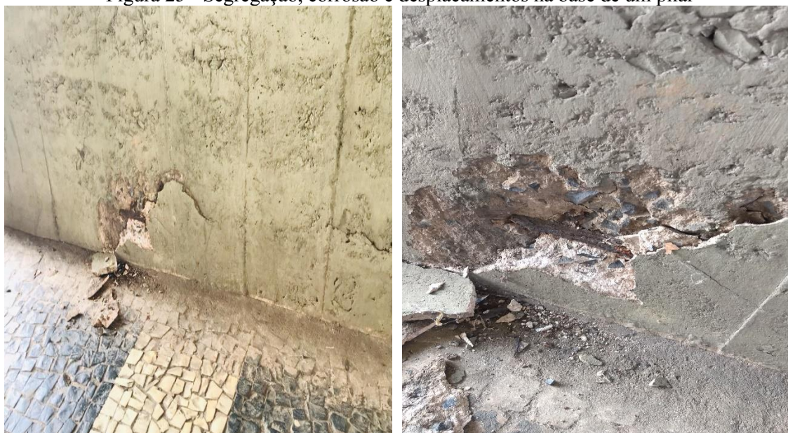
Figura 25 - Segregação, corrosão e deslocamentos na base de um pilar
