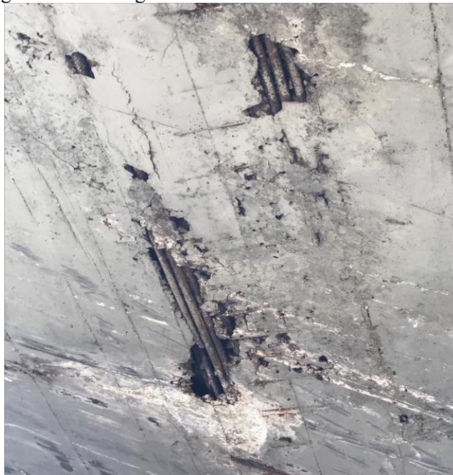
Figura 15 - Patologias diversas na face inferior do tabuleiro
