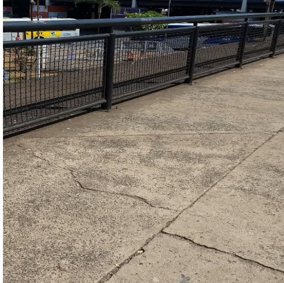
Figura 19 - Passeio com alguma fissuração
