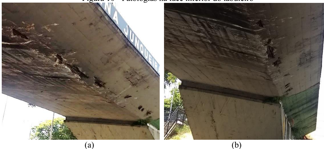
Figura 10 - Patologias na face inferior do tabuleiro
