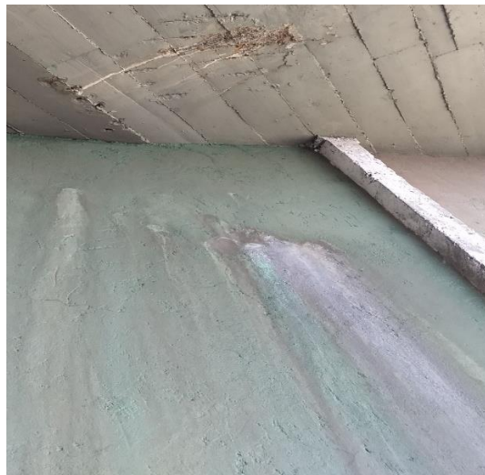
Figura 34 - Carbonatação e/ou eflorescências na cortina de concreto e face inferior do tabuleiro
