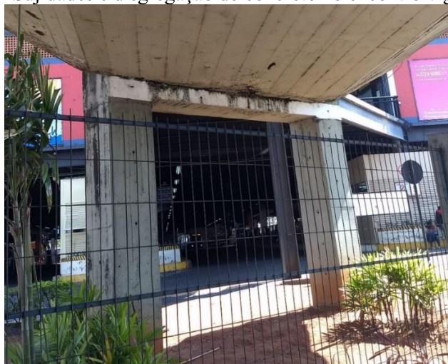
Figura 16 - Sujidades e disgregação do concreto no encontro viga-tabuleiro
