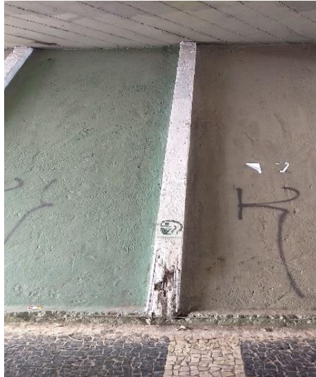
Figura 32 - Patologias diversas na base de um pilar pertencente à cortina de concreto dos encontros do viaduto
