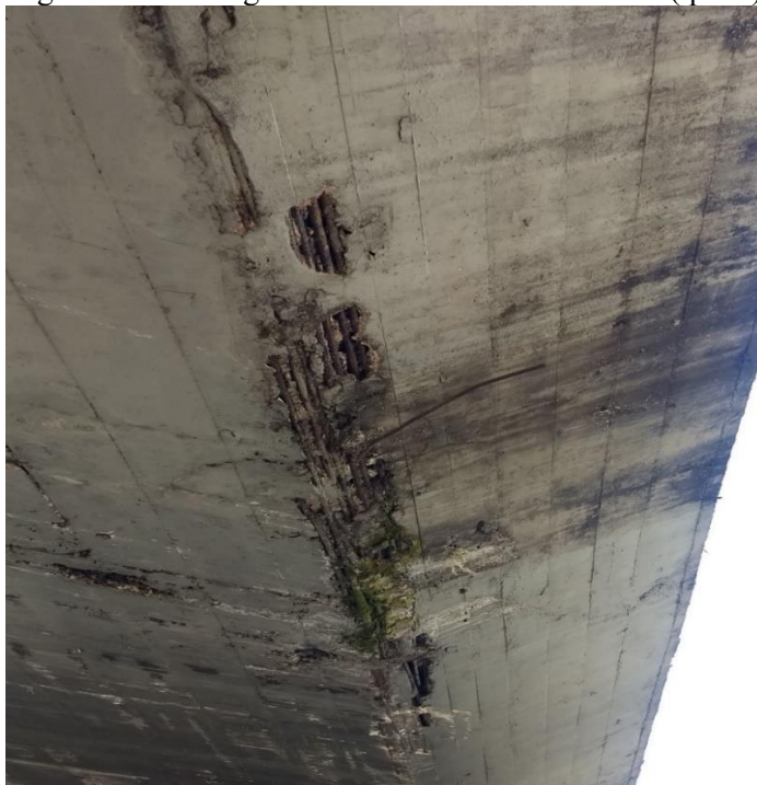
Figura 11 - Patologias na face inferior do tabuleiro (quina)
