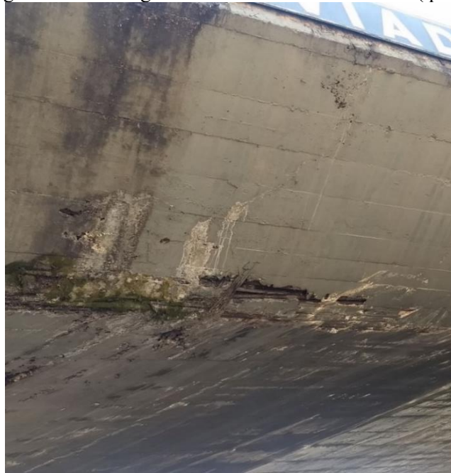
Figura 12 – Patologias na face inferior do tabuleiro (quina)
