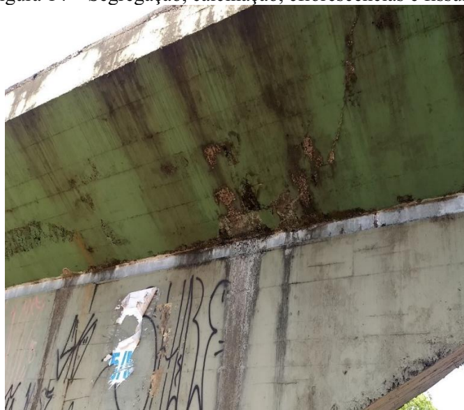
Figura 14 – Segregação, calcinação, eflorescências e fissuras
