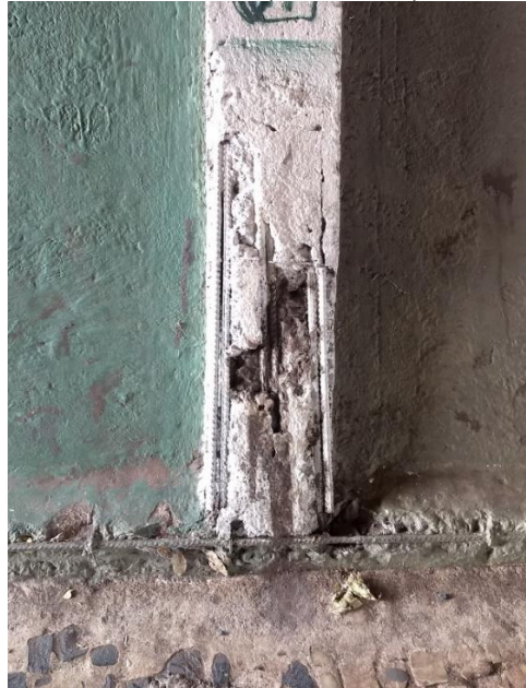
Figura 33 - Patologias diversas na base de um pilar pertencente à cortina de concreto dos encontros do viaduto (em detalhe)
