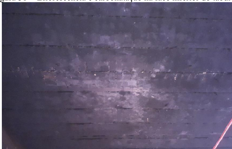
Figura 38 - Eflorescência e carbonatação na face inferior do tabuleiro
