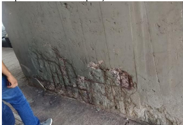
Figura 28 - Segregação, deslocamento com exposição e corrosão da armadura na base de um pilar
