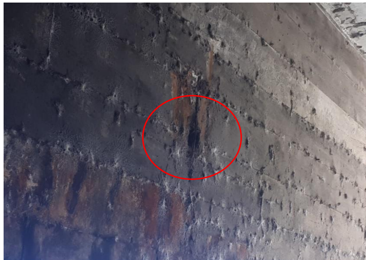
Figura 37 - Eflorescência, carbonatação, manchas de ferrugem e tubo de drenagem com interferência de armadura
