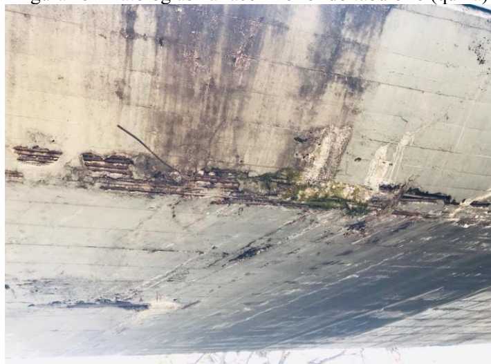
Figura 13 - Patologias na face inferior do tabuleiro (quina)
