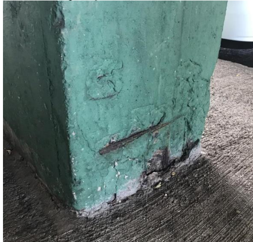
Figura 26 - Deslocamento, exposição e corrosão da armadura na base de um pilar
