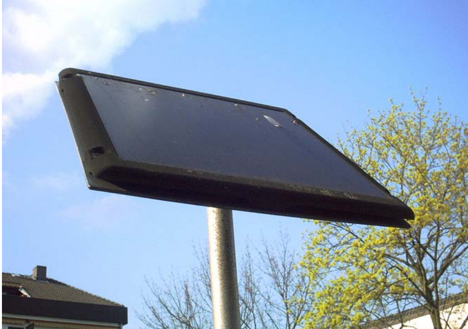
Figura 19 – Módulo fotovoltaico sombreado por fezes de pássaros em Karlsplatz, Kassel – Alemanha.
