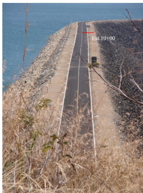
Figura 1 – Deslocamento horizontal da crista da barragem
