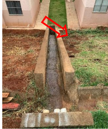
Foto 8: Deslizamento de Talude
