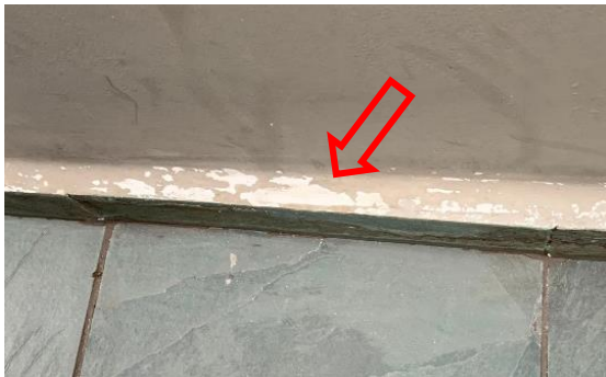
Foto 11: Desplacamento da pintura
