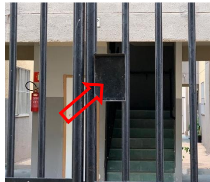
Foto 46: Ausência de interfone
