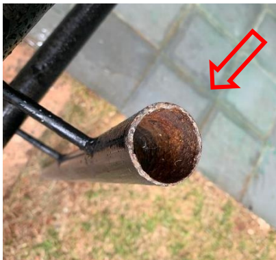
Foto 50: Ferrugem no suporte do corrimão
