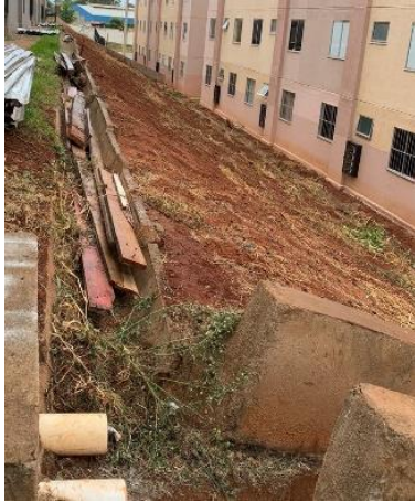
Foto 7: Deslizamento de Talude
