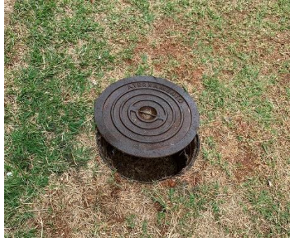
Foto 47: Aterramento não conectado a cabos de condução da descarga elétrica atmosférica
