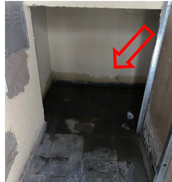
Foto 49: Infiltração por impermeabilização inadequada das vigas baldrame
