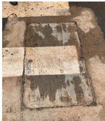
Foto 51: Obstrução de caixa de drenagem pluvial
