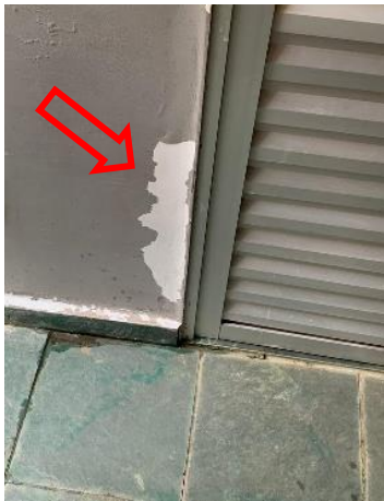
Foto 9: Desplacamento da pintura
