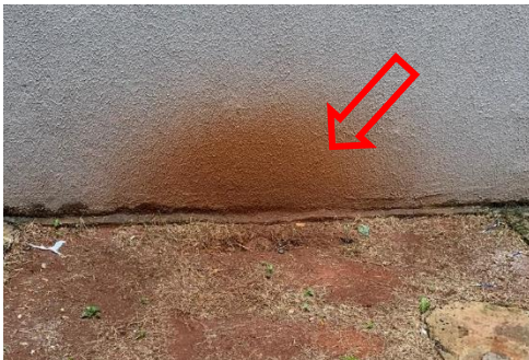
Foto 48: Infiltração por impermeabilização inadequada das vigas baldrame
