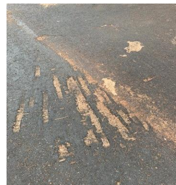
Foto 52: Desgaste e deterioração do pavimento asfáltico
