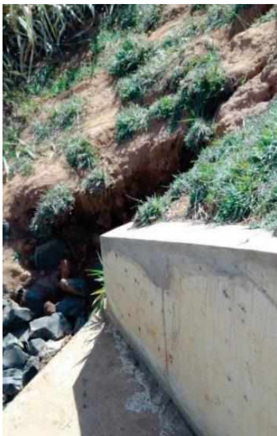
Imagem 14 – Processo de erosão no sistema de lançamento final de drenagem pluvial
