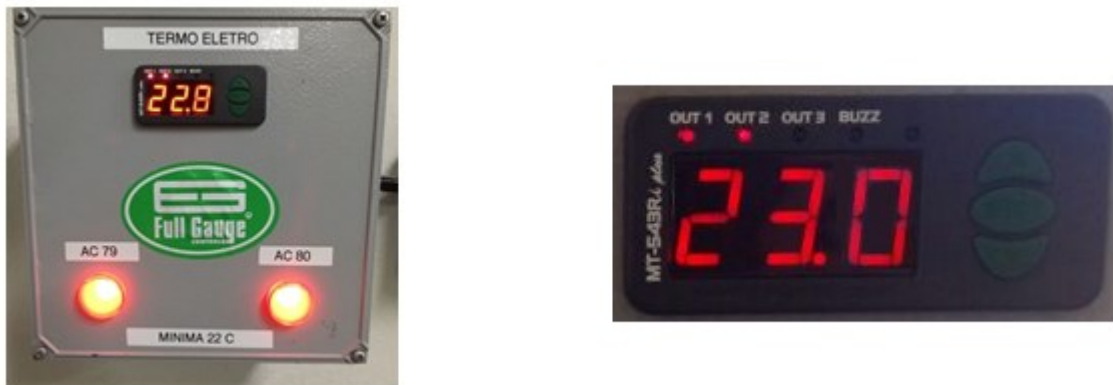
Figura 10: Controlador Full Gauge MT-543R instalado para acionamento de 2 equipamentos de ar condicionado para funcionamento simultâneo e de acordo com seu horário programado.
