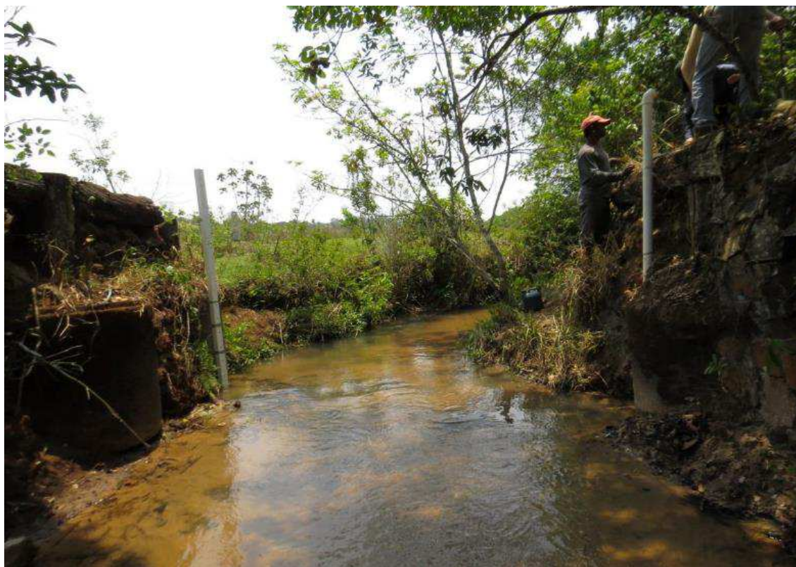
FIGURA 8: Sensor de nível instalado na Bacia Hidrográfica Experimental do Córrego Glória
