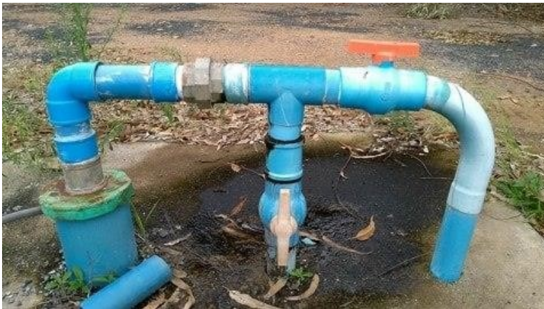
FIGURA 21 – Sistema de captação por poço tubular da Propriedade A.
