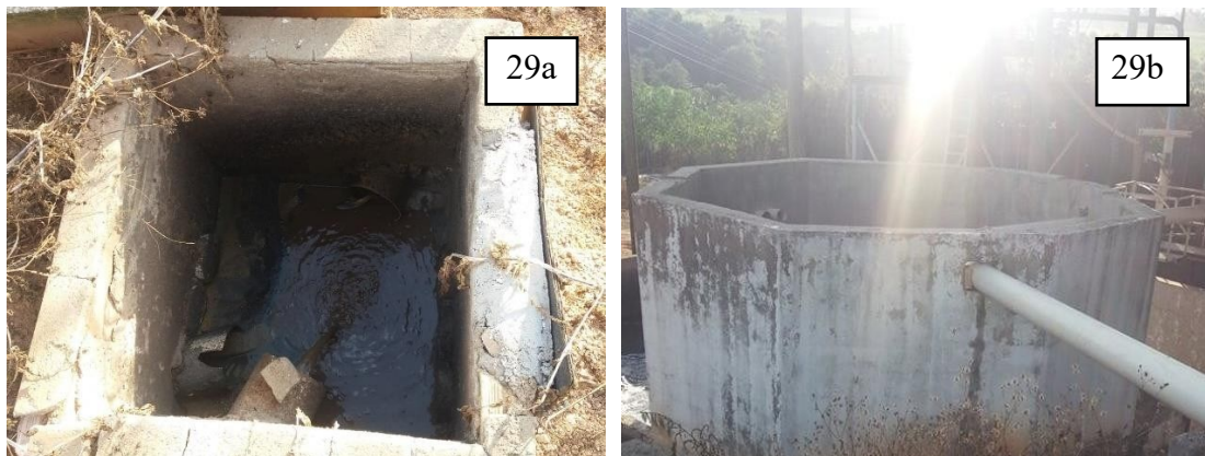
29a – Caixa de inspeção. 29b – Tanque de equalização Fonte: do autor, 2019.
