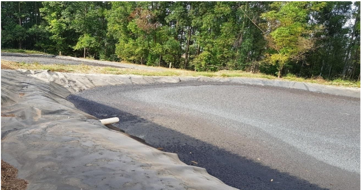
FIGURA 26 – Lagoa de estabilização 2 da Propriedade B.
