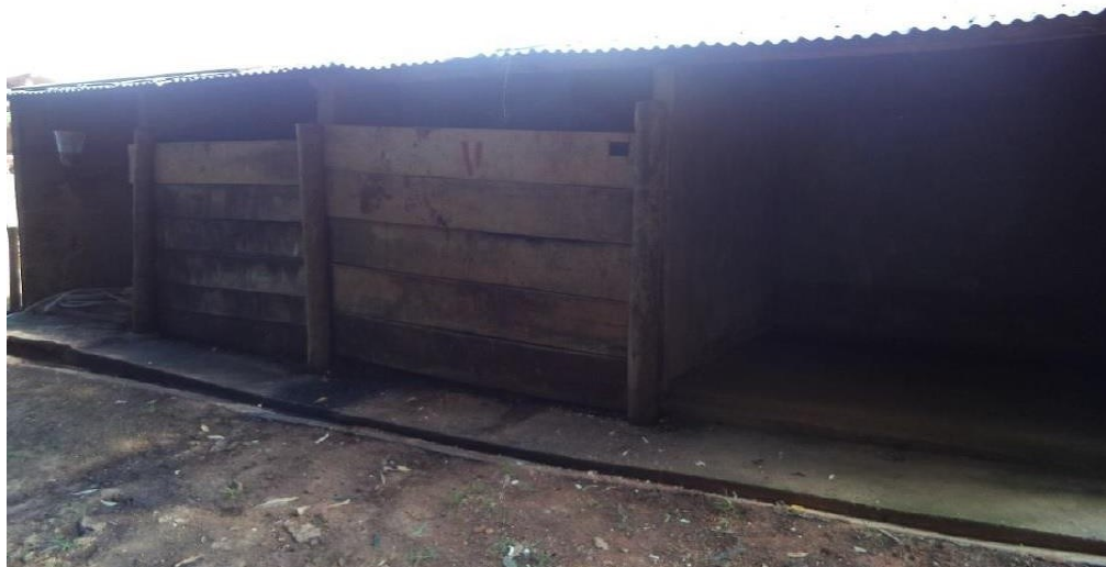
FIGURA 22 – Área de compostagem dos suínos mortos da Propriedade B.
