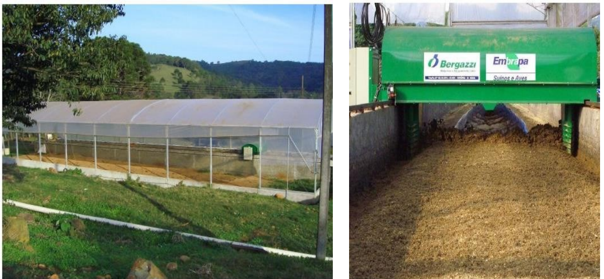
FIGURA 3 – Unidade de compostagem automatizada instalada em Concórdia - SC.
