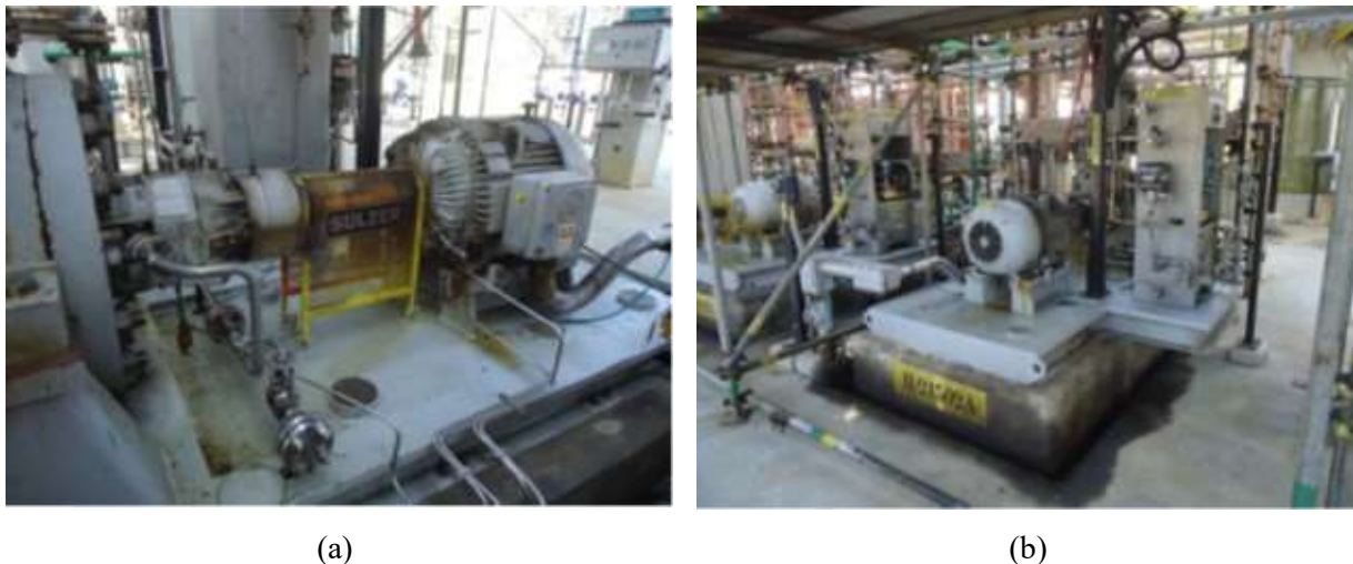
Figura 20 – Motores de indução trifásicos acionando sistemas de bombeamento em uma Refinaria da Petrobras.
