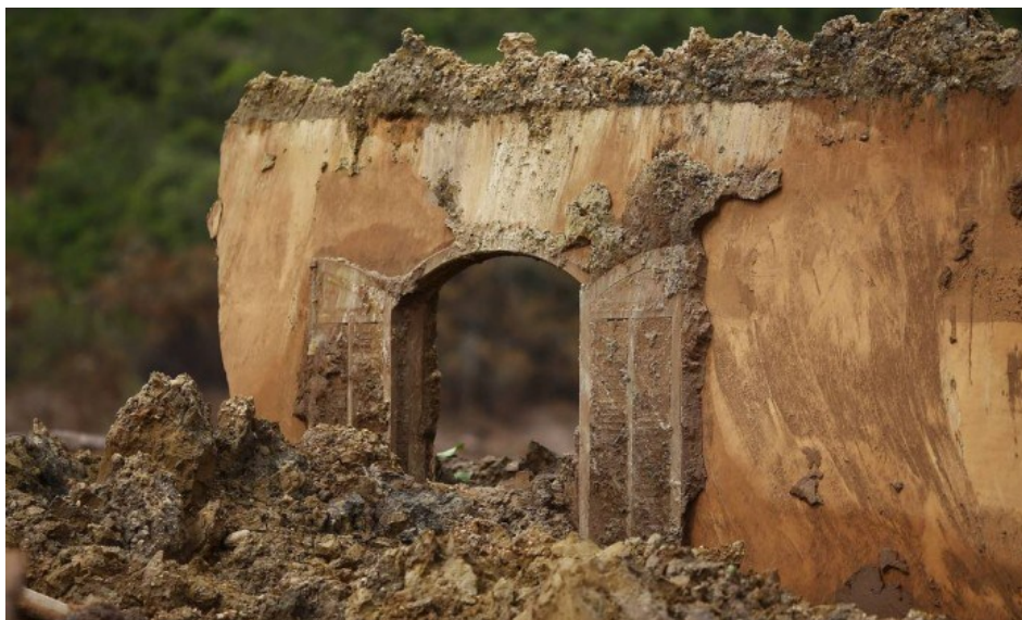
Figura 37: Fotografia da janela de uma casa de Bento Rodrigues, no interior de Minas Gerais, é vista após o rompimento de barragens de rejeitos da mineradora Samarco
