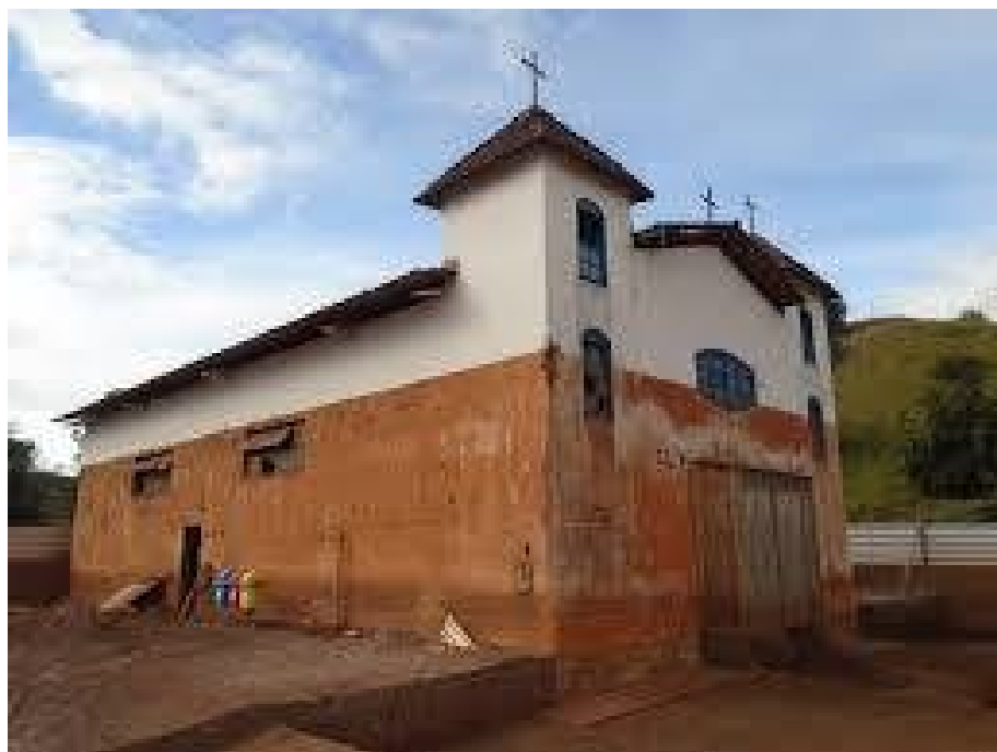
Figura 47: Fotografia da Igreja de Santo Antônio após o rompimento da Barragem de Fundão em 2016, com marca escura da lama nas alvenarias no distrito de Paracatu de Baixo.
