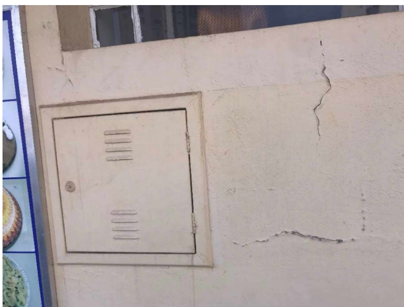
Figura 87- Exemplo de fissuras horizontais e diagonais no Mercado Municipal
