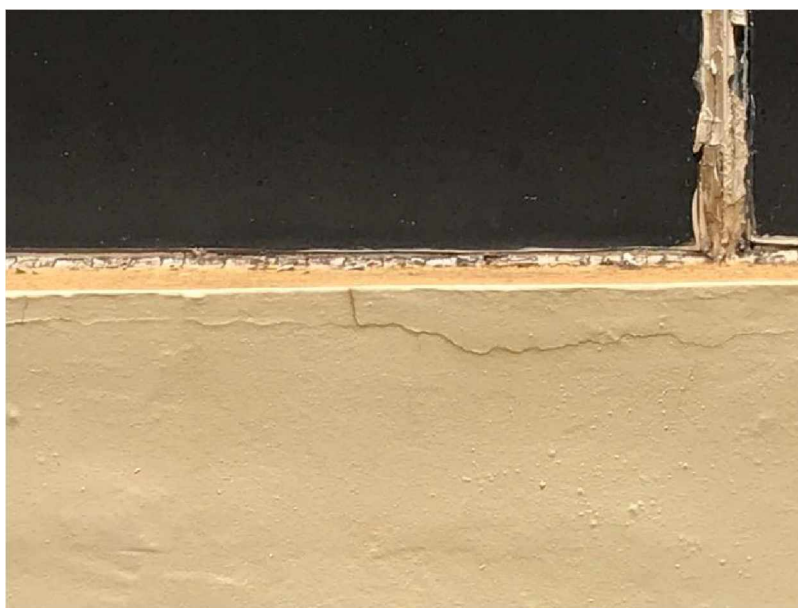
Figura 92 - Exemplo de lesão na interface alvenaria esquadria na Biblioteca JK
