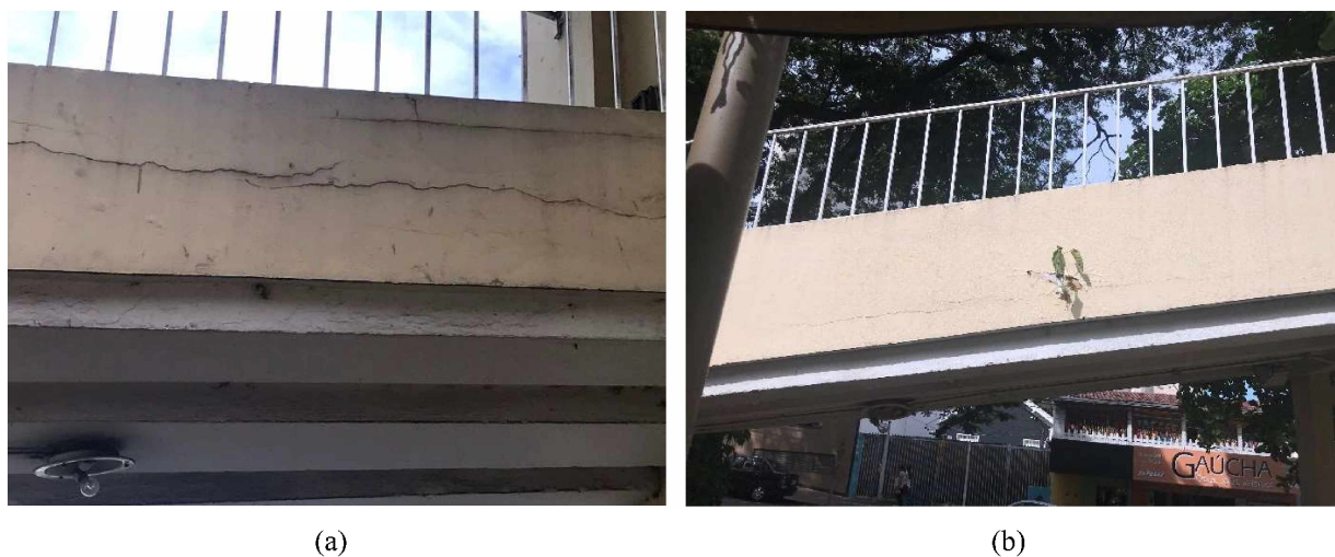
Figura 78- Patologias em rampa
