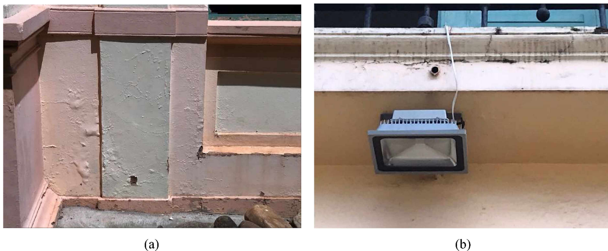
Figura 28 - Infiltrações em F1
