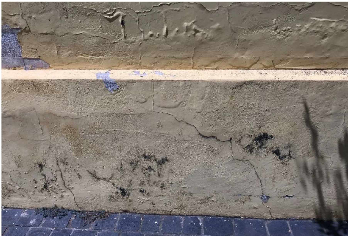
Figura 85 - Exemplo de anomalias em soco na Biblioteca JK
