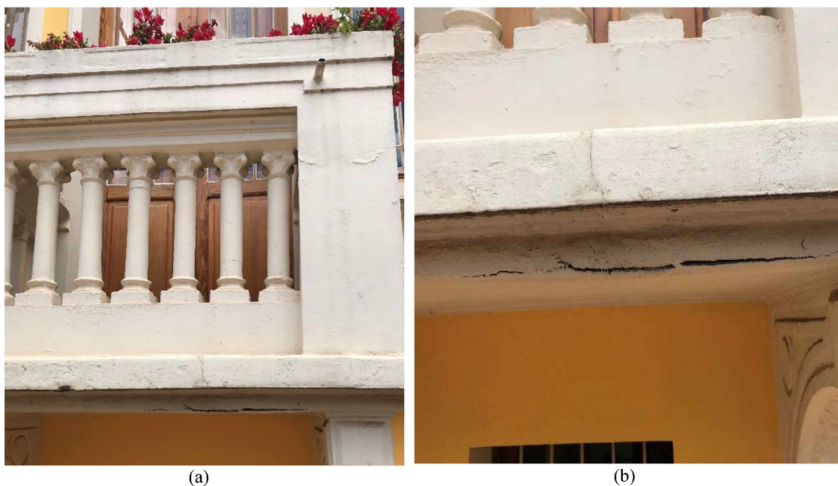
Figura 58 - Infiltrações na sacada
