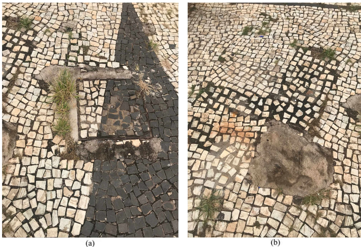
Figura 68 - Patologias encontradas no calçamento
