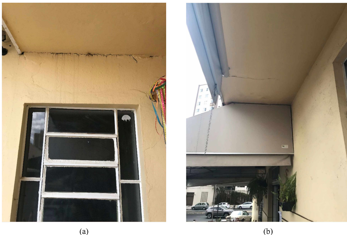
Figura 75 - Fissuras em marquises e apoios
