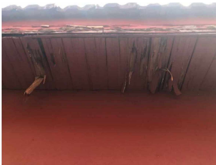
Figura 47 - Patologias em beirais
