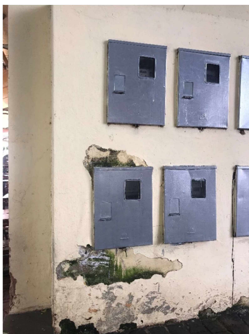
Figura 79 - Infiltração e aparecimento de musgo
