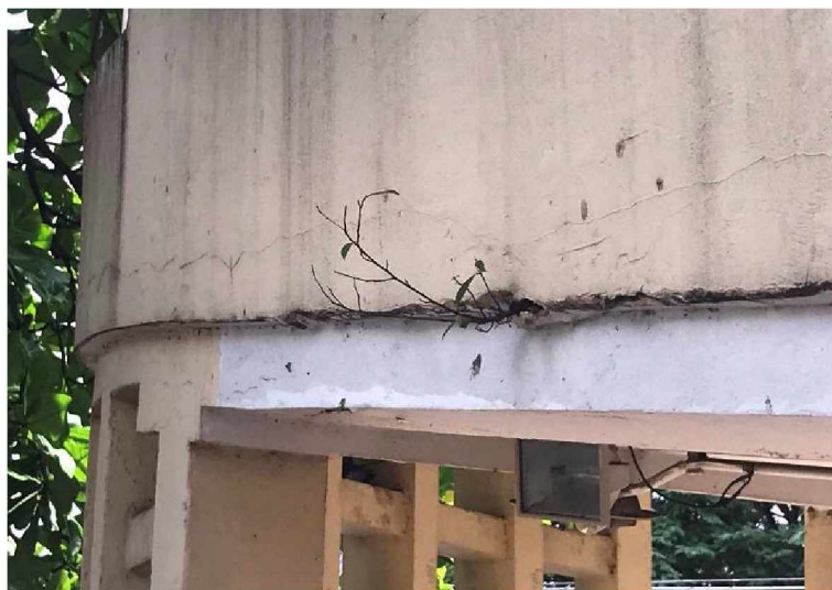
Figura 94 - Exemplo de patologia vegetal instalada na rampa do Mercado Municipal
