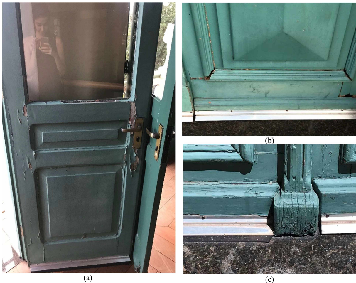
Figura 26- Deterioração de portas
