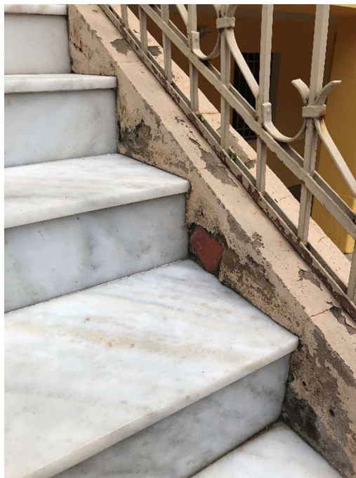
Figura 56 – Infiltrações na escada
