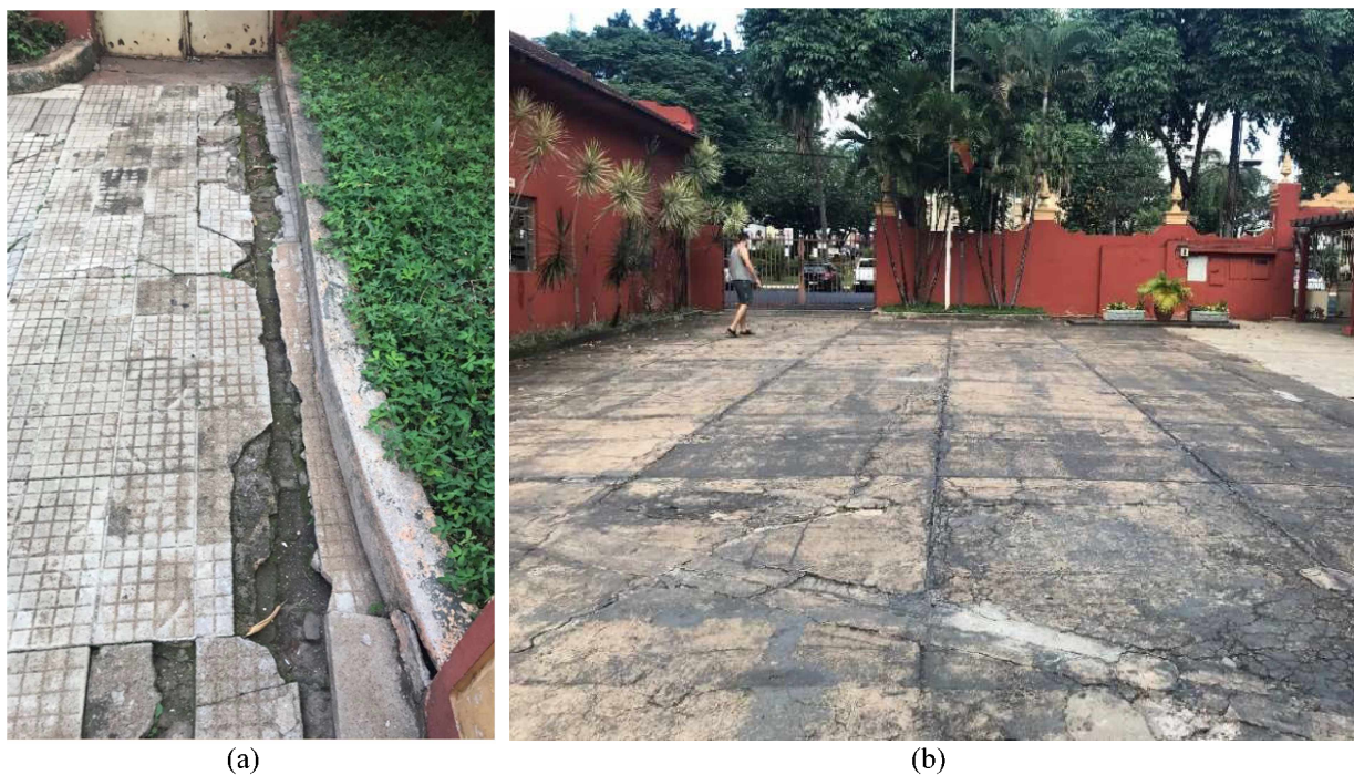
Figura 45 - Patologias encontradas em pisos
