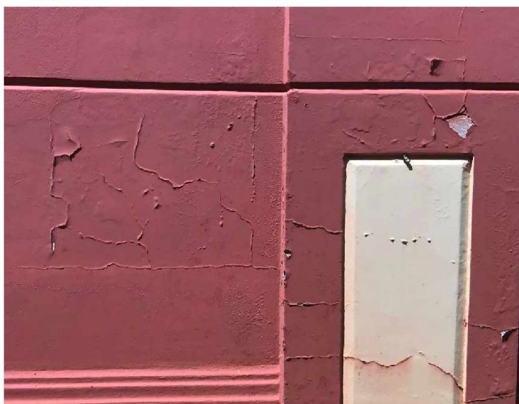
Figura 88 - Exemplo de fissuração tipo mapeamento em pano cego da Oficina Cultural
