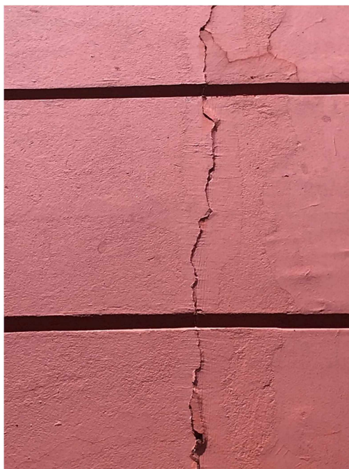
Figura 86 - Exemplo de fissura vertical em pano cego da Oficina Cultural
