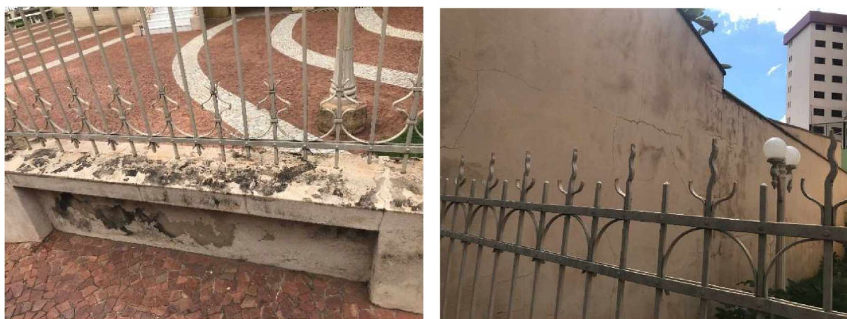
Figura 54 - Falta de manutenção de muros e demais áreas externas
