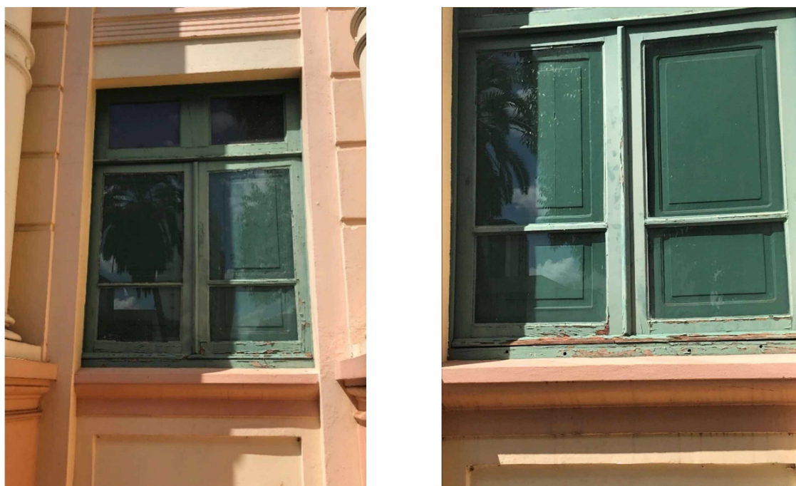
Figura 27 - Patologias do lado externo em janelas
