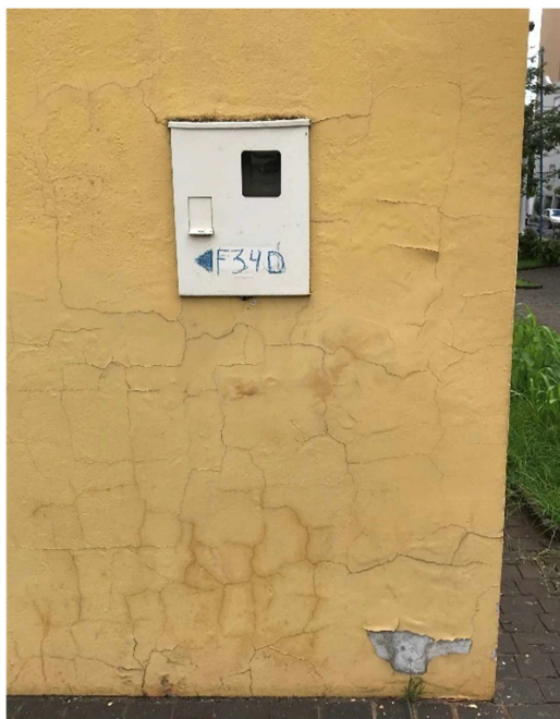
Figura 20 - Infiltrações, fissuras e descolamento em F2
