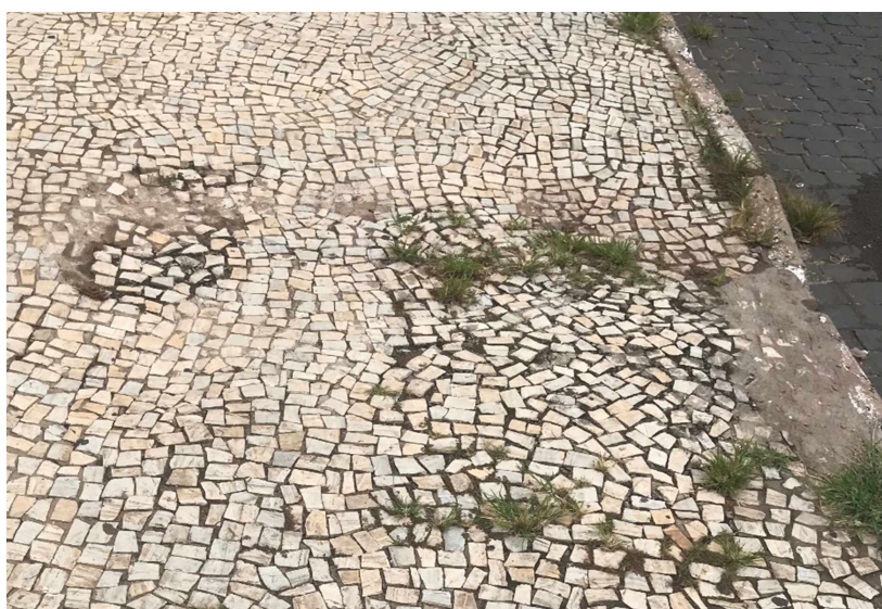
Figura 93 - Exemplo de lesão no calçamento ao redor da Igreja N. Sra do Rosário
