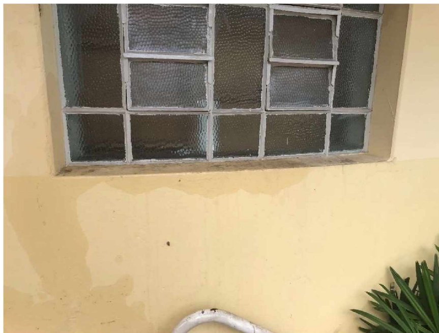
Figura 77 - Infiltrações em peitoris
