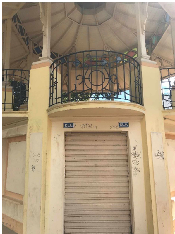
Figura 32 - Falta de manutenção e vandalismo do coreto
