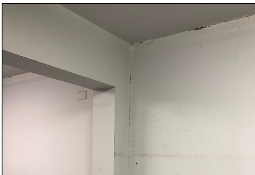
Figura 38- Fissuras associadas a movimentação térmica no Almojarifado.
