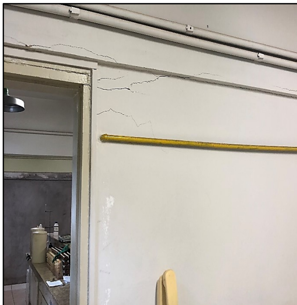
Figura 34- Fissuras associadas a retração da laje no bloco 4C.
