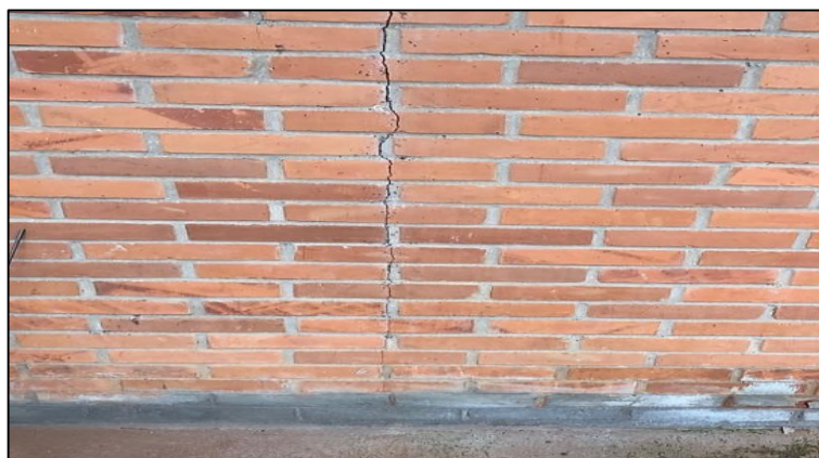
Figura 30- Fissura vertical na alvenaria da fachada no Bloco 4C.
