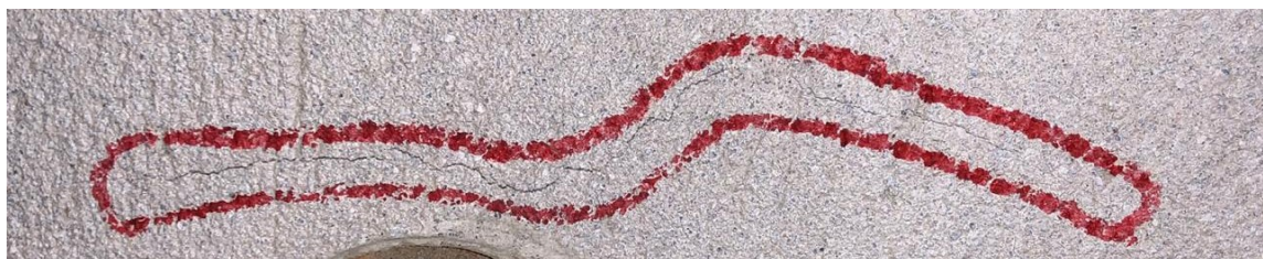
Figura 27 – Ampliação de fissura no painel de argamassa.
