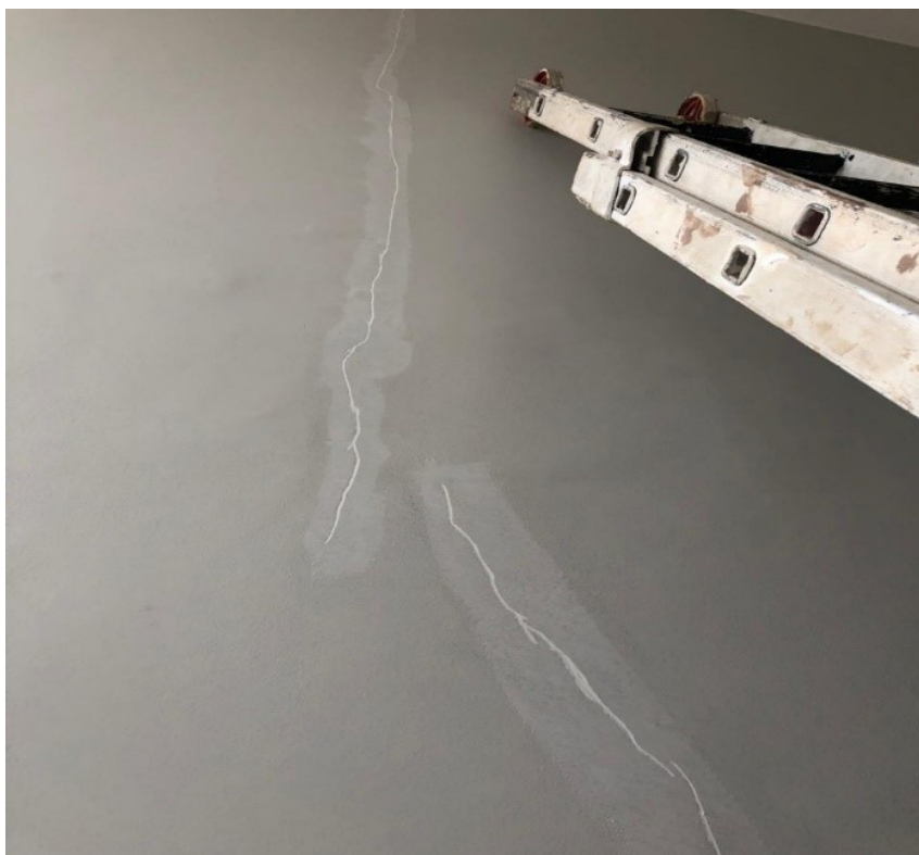
Figura 1 – Fissuras na argamassa de revestimento.
