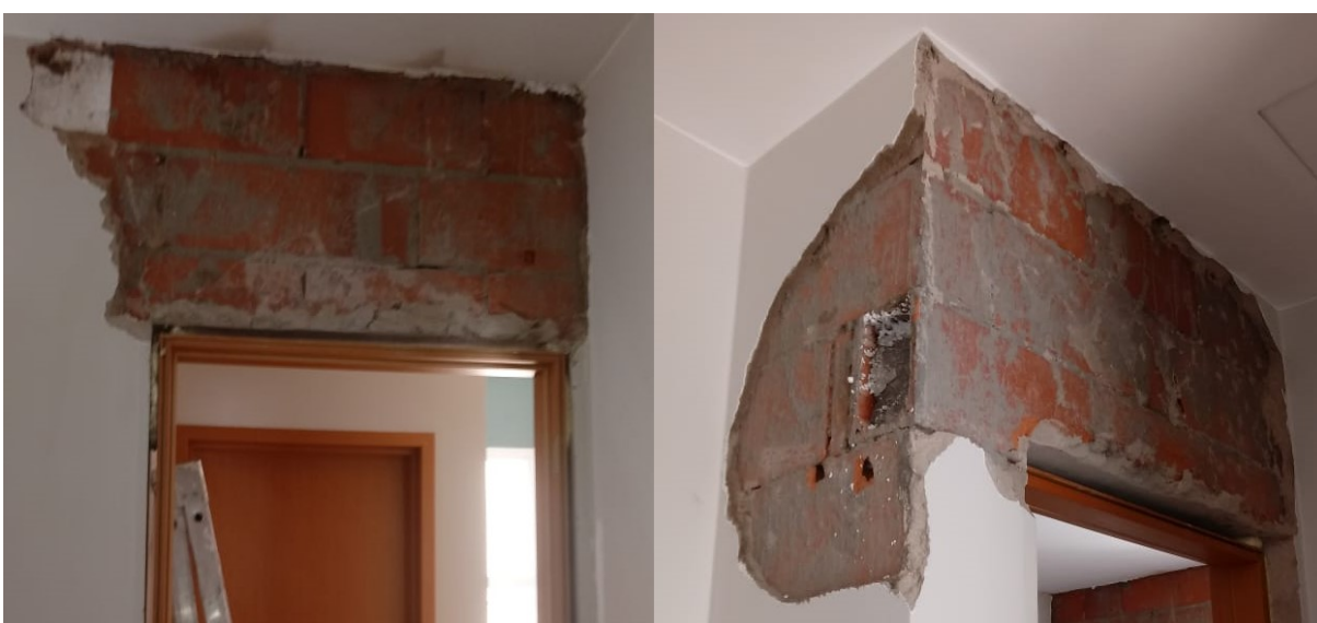
Figura 3 – Substrato sem chapisco e com deslocamento da argamassa de revestimento.
