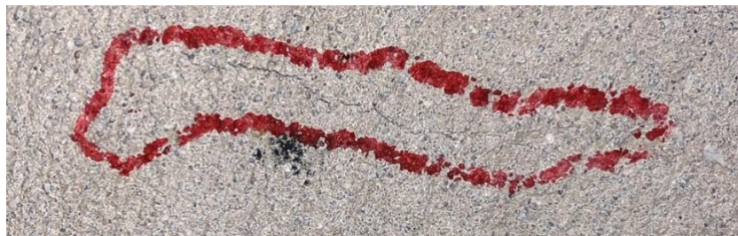
Figura 26 – Ampliação de fissura no painel de argamassa.
