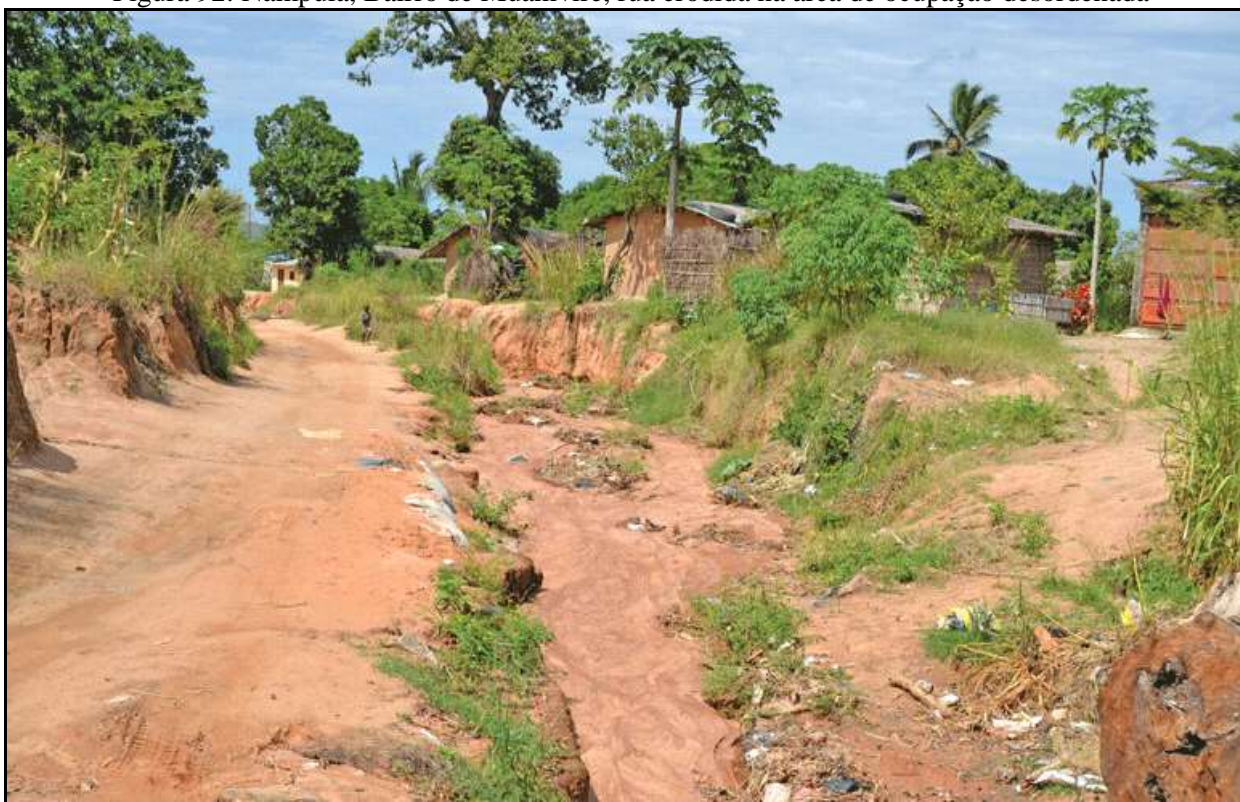
Figura 92: Nampula, Bairro de Muahivire, rua erodida na área de ocupação desordenada
