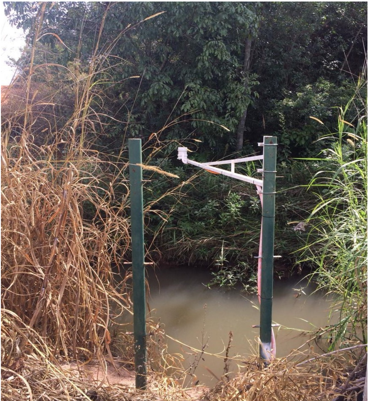
Foto 2 – Sensor de nível ultrassônico da estação hidrométrica da Bacia Hidrográfica Experimental do Córrego Água Vermelha – BHEAV
