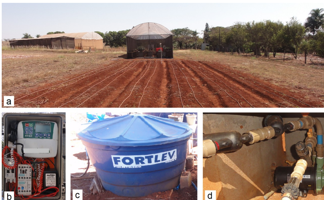
FIGURA 3.5 Principais equipamentos de irrigação utilizados: a) tubos gotejadores distribuídos na área de cultivo; b) conjunto de automação; c) reservatório de água, e; d) conjunto motobomba e filtragem.
