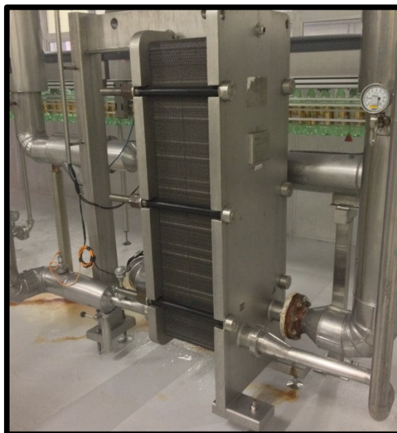
Figura 9 - Trocador de calor na sala de envase
