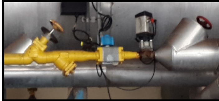
Figura 12 - Válvula de Expansão e Válvula Solenóide do sistema de Refrigeração
