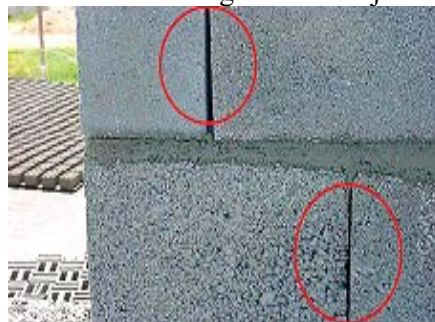
Figura 12 – Ausência de argamassa nas juntas verticais
