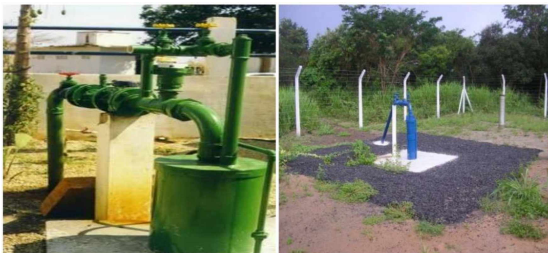
Figuras 4 e 5 – Captações por meio de poços tubulares.
