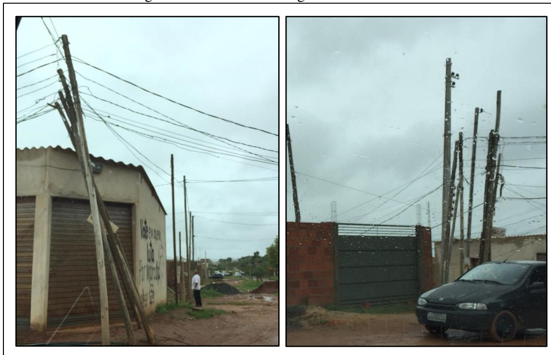
Figura 23 – Postes de energia elétrica no bairro
