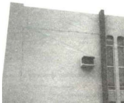
Figura 3 – Fissuras causadas por movimentações térmicas diferenciadas.
