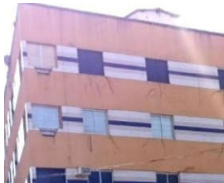
Figura 6 – Fissuração na região das aberturas.
