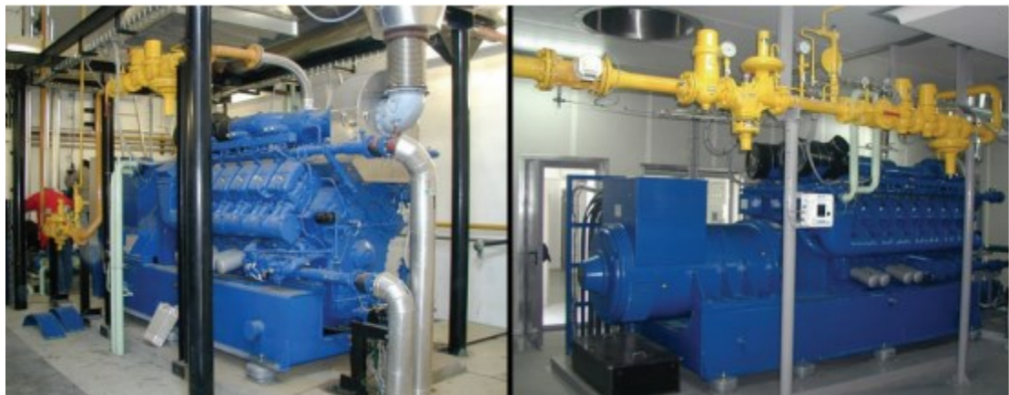
Figura 11 - Motor a gás operando num sistema de geração de energia
