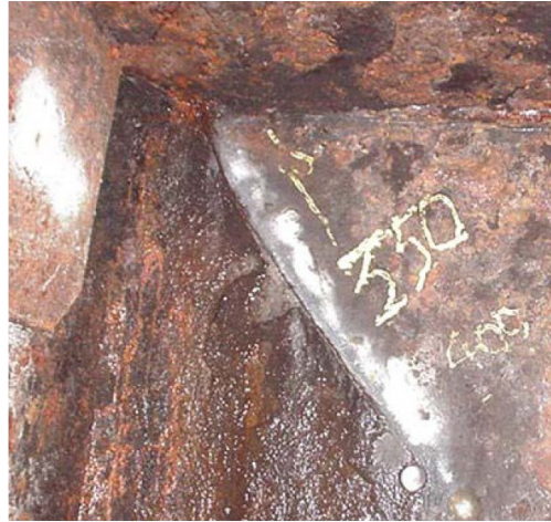
Figura 1.1 - Tanque trincado de armazenamento de um FPSO da PETROBRAS (SOUZA, 2006).
