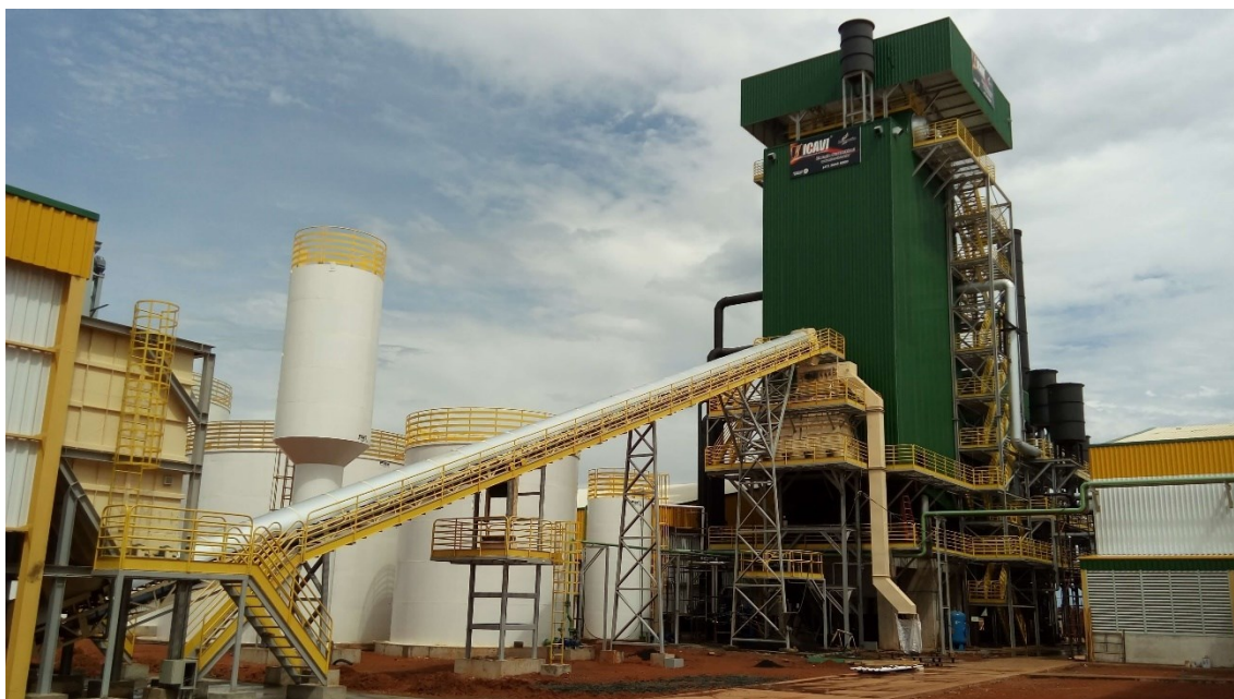
Figura 6: Caldeira Aquatubular ICAVI (Fonte: www.icavi.ind.br , 2017)
