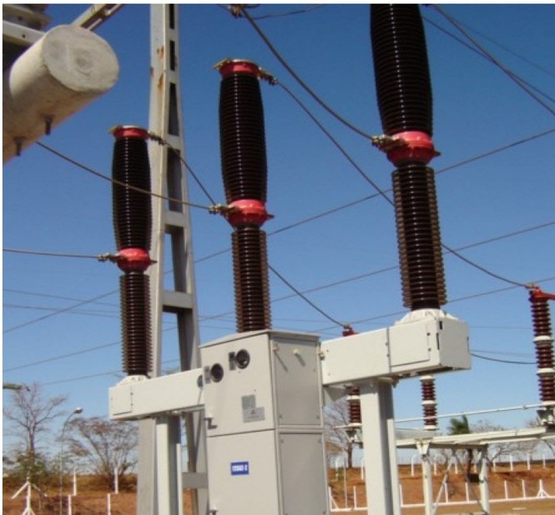
Figura 11 - Disjuntor de alta tensão [13]
