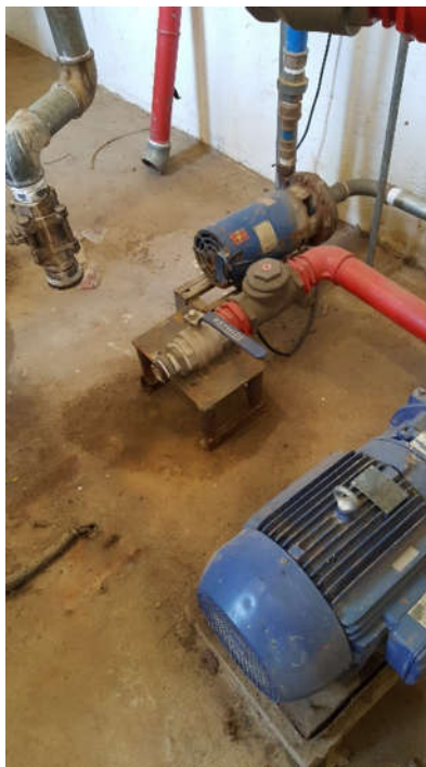
Figura 2 - Sala de bombas (Situação anterior).
