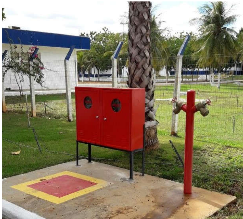
Figura 4 - Hidrante e abrigo metálico.
