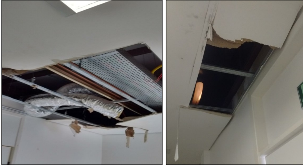
Figura 67 – Falha de impermeabilização no telhado
