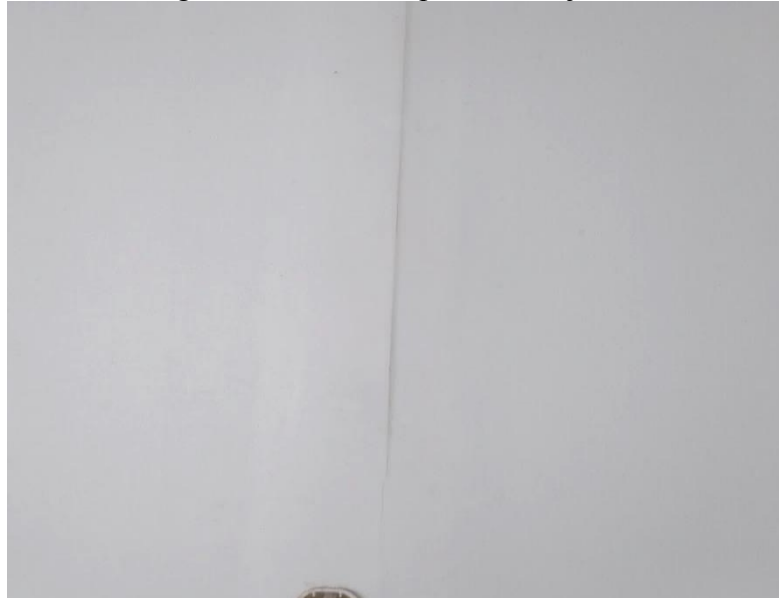
Figura 53 – Fissura aparente em juntas
