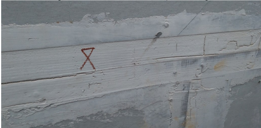
Figura 75 – Fissuras devido à ação do tempo
