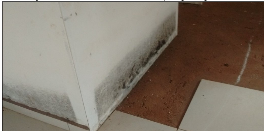
Figura 42 – Mofo oriundo de infiltrações por capilaridade
