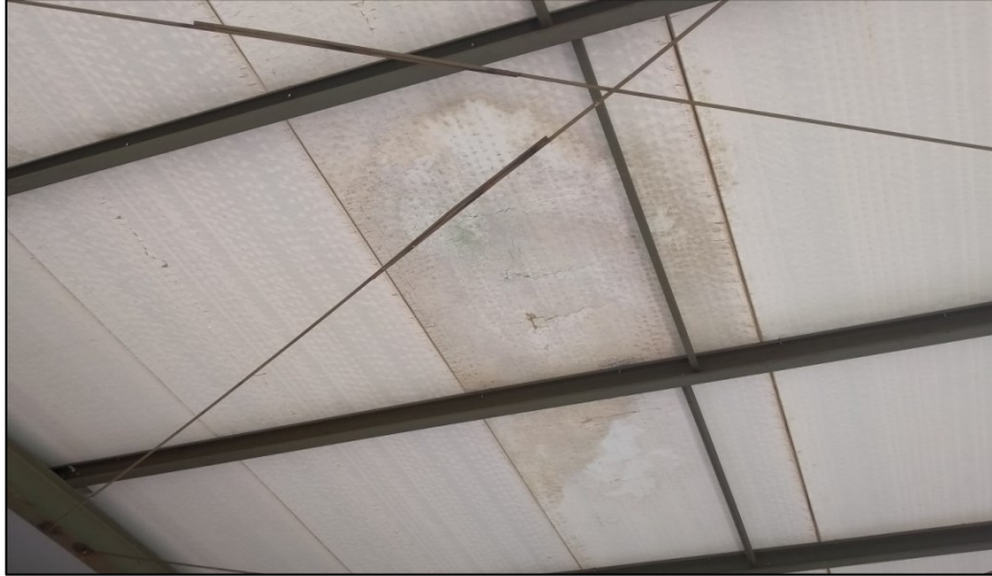
Figura 39 – Infiltração no telhado
