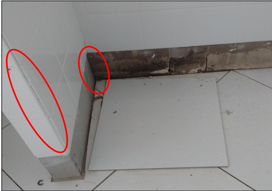
Figura 51 - Falta de tratamento de quinas e ângulos de 90°
