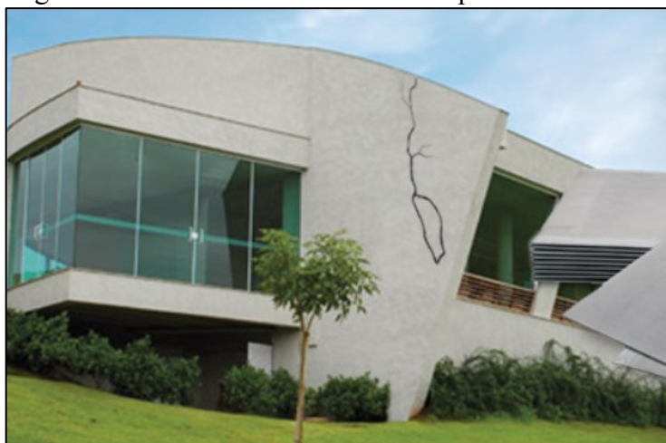
Figura 16 – Trincas e fissuras entre as placas cimentícias
