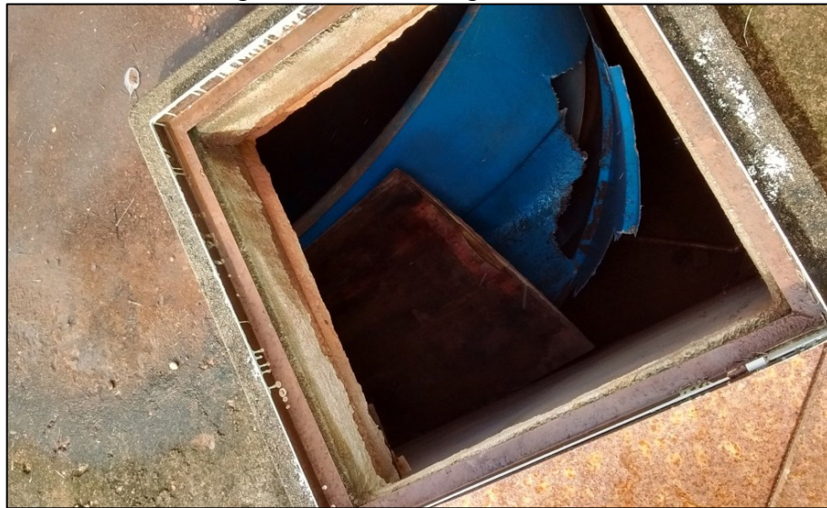
Figura 36 – Caixa d'água confinada
