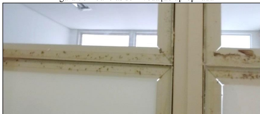
Figura 70 – Janelas sem vedação apropriada
