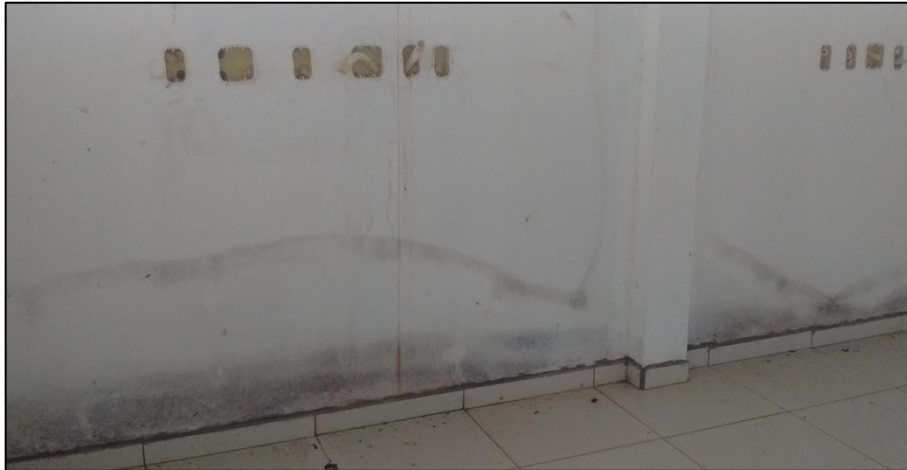
Figura 43 – Paredes internas com mofo
