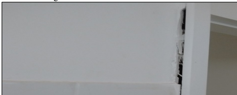
Figura 73 – Portal assentado com defeito
