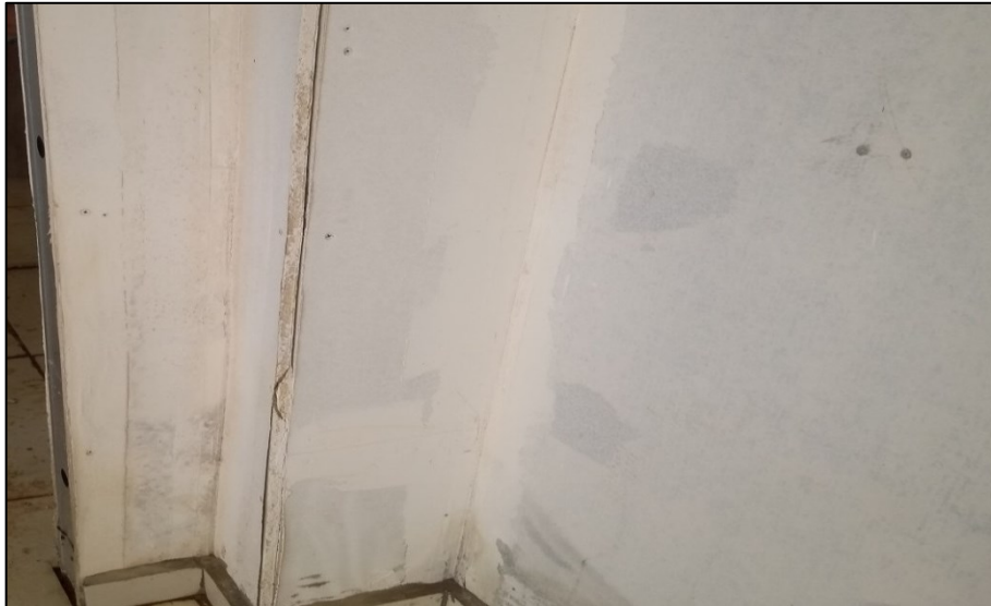
Figura 50 – Quinas com pintura sem tratamento de quina
