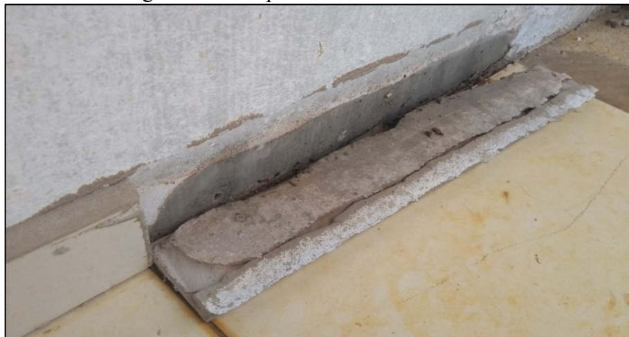
Figura 58 – Desplacamento de revertimento
