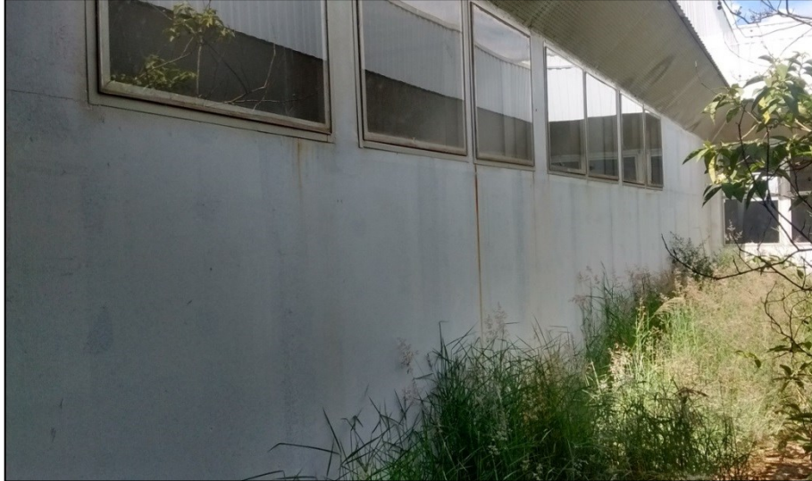
Figura 47 – Janelas com falha de impermeabilização
