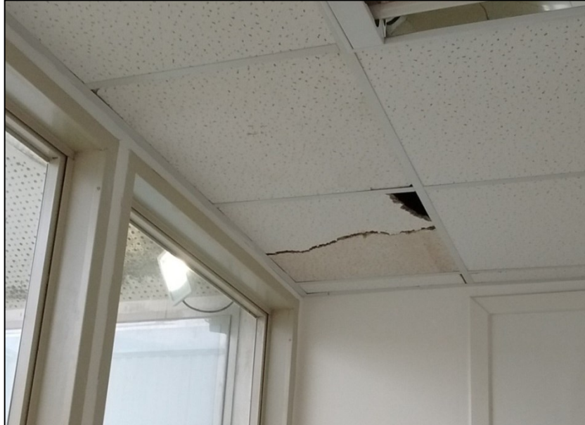
Figura 65 – Placas trincadas devido às infiltrações
