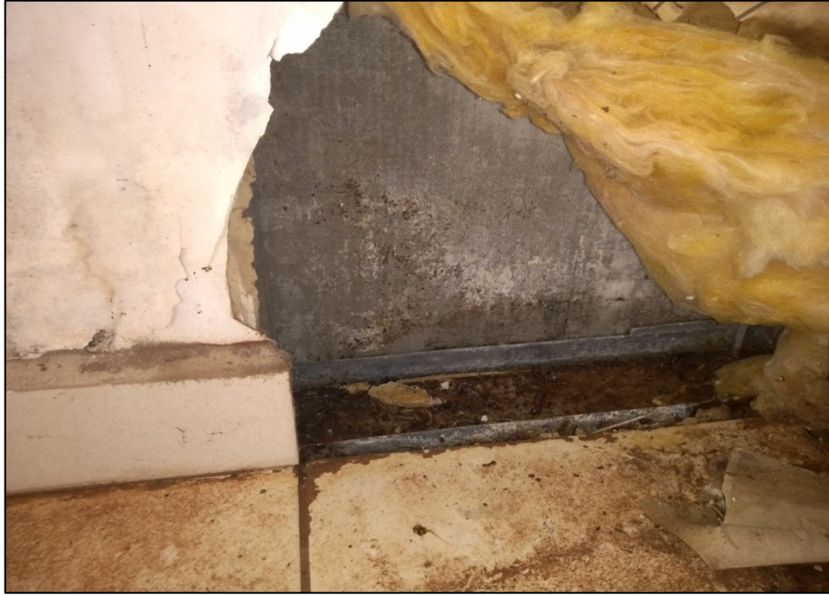
Figura 45 – Deterioração das paredes
