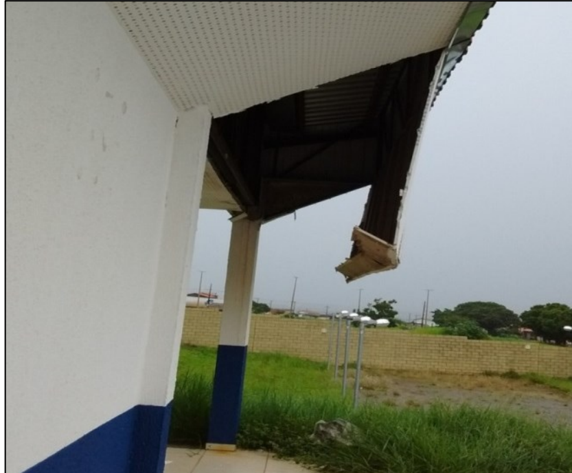
Figura 63 – Forro de fachada externa desprendido
