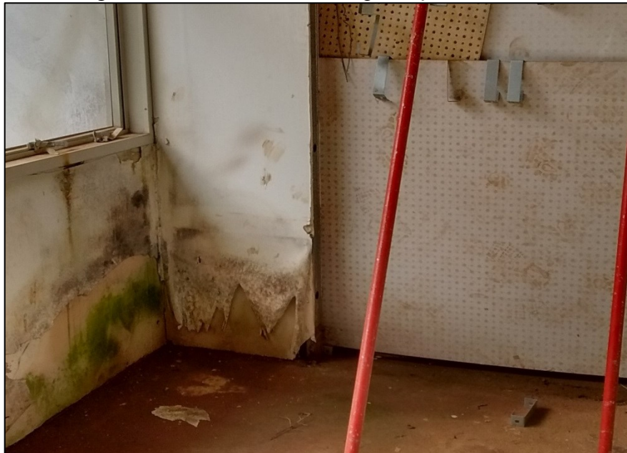
Figura 60 – Parede deteriorada pela ação da umidade
