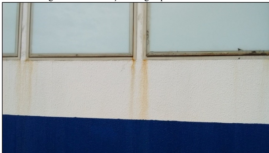
Figura 69 – Infiltração de água pelos contramarcos
