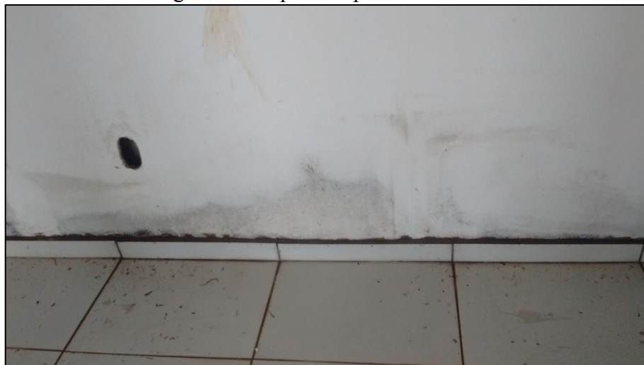
Figura 44- Reparo de parede incorreto
