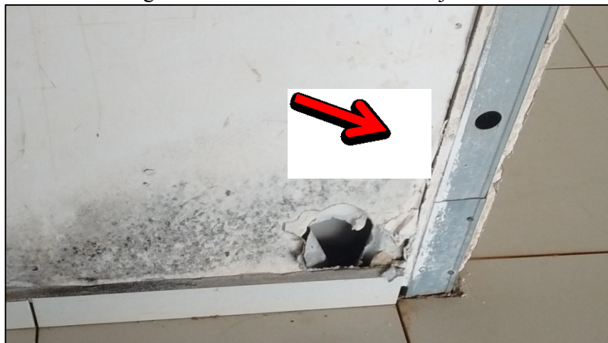
Figura 54 - Falta de tratamento de juntas
