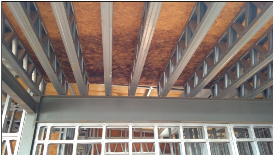
Figura 78 – Sinais de infiltração em telhado
