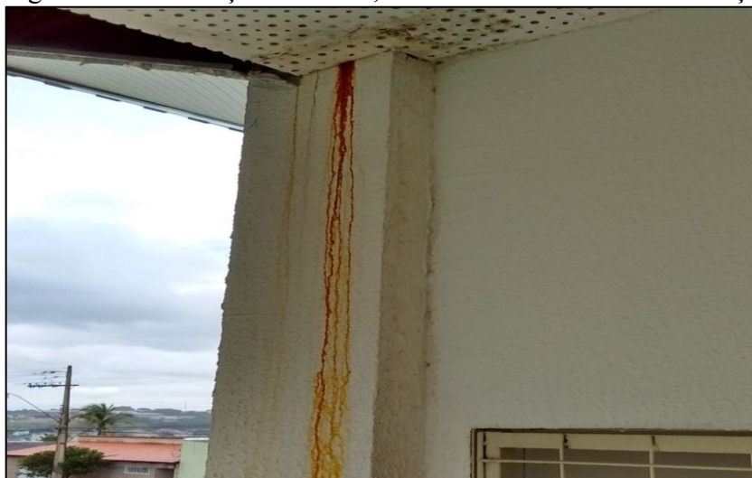
Figura 66 – Infiltração em forro, sinais de dano a estrutura de aço
