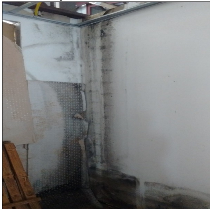
Figura 40 – Paredes com bolor
