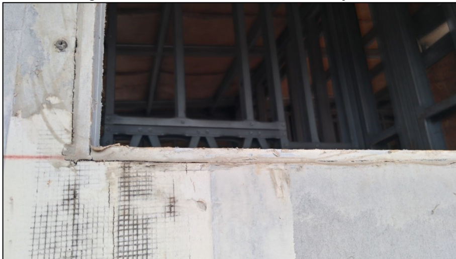
Figura 76 – Fissuras em contramarcos de janelas
