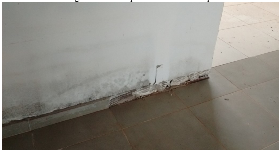
Figura 46 - Deslocamento de rodapé
