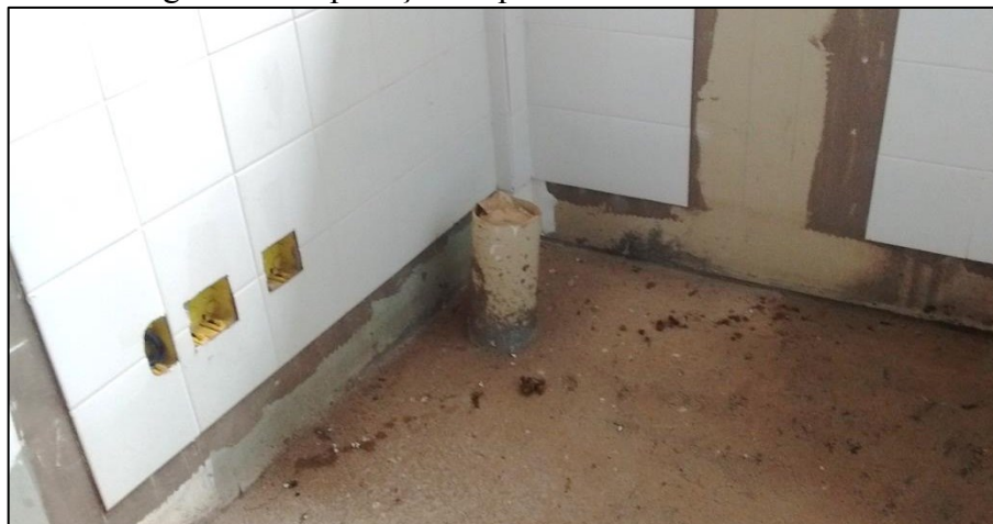
Figura 25 – Aplicação de placas em locais incorretos
