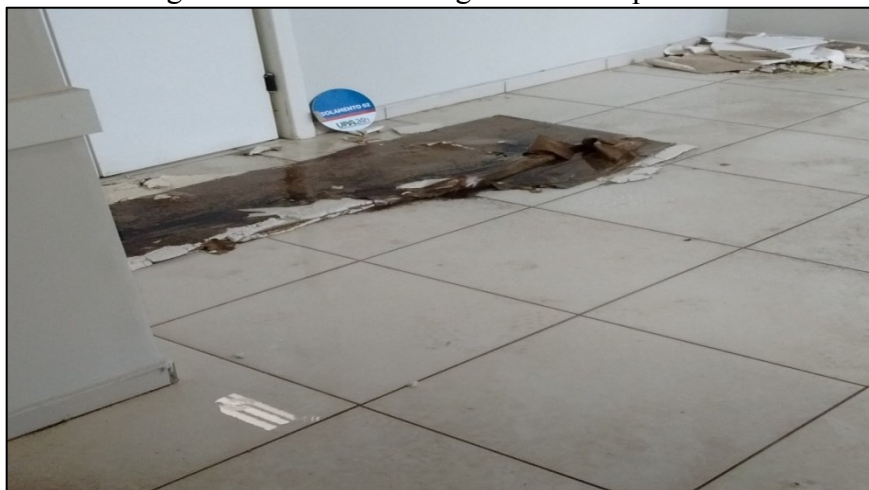
Figura 68 – Entrada de água da chuva pelo teto
