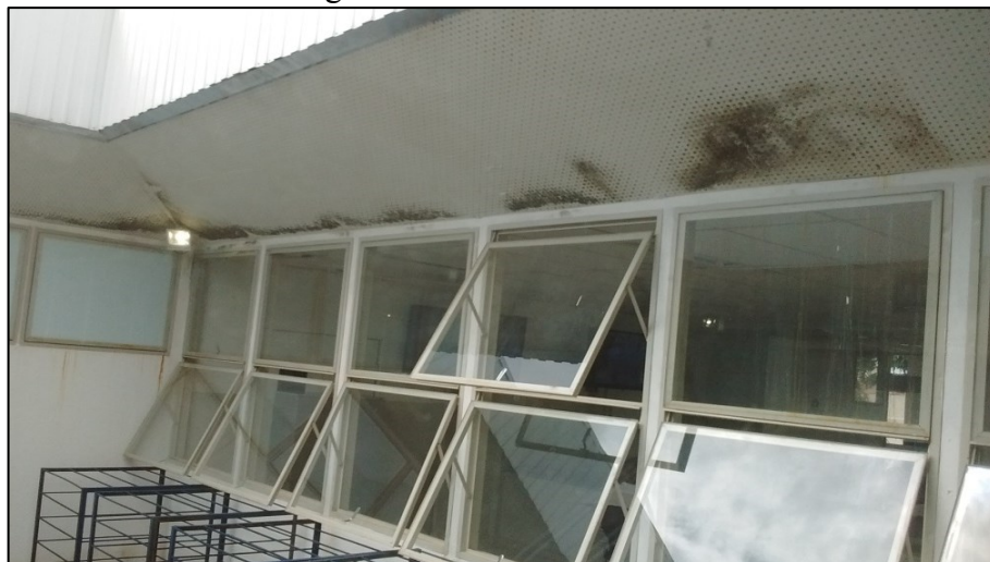
Figura 62 – Mofo em fachada
