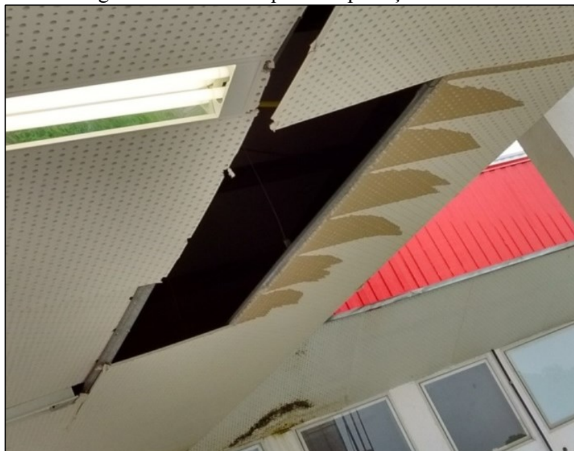
Figura 64 – Forro despendido por ação do clima
