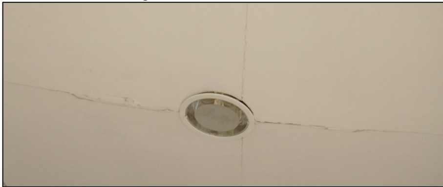
Figura 72 – Fissuras em telado
