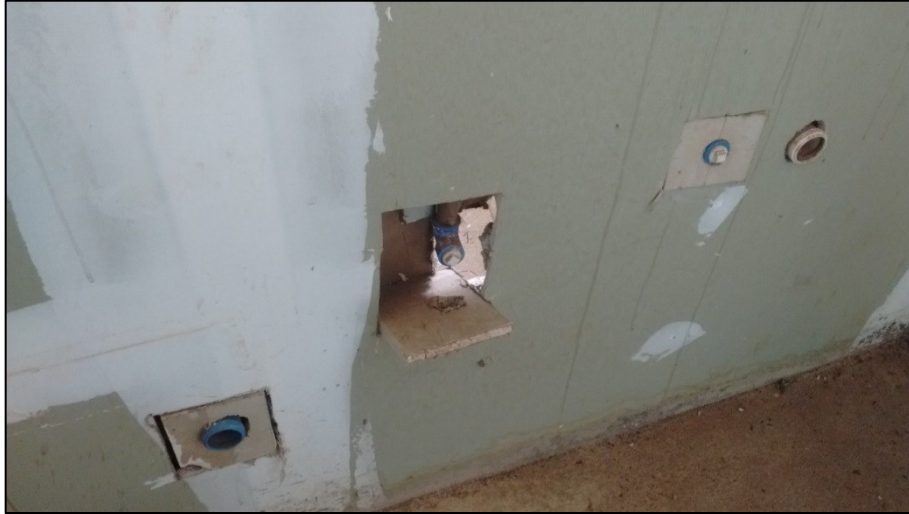
Figura 28 – Aplicação de retalho com material incorreto
