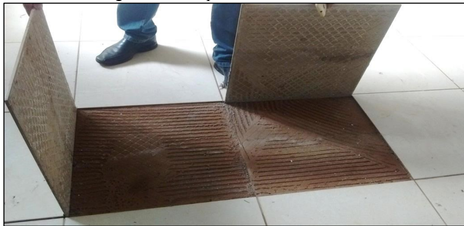
Figura 57 – Desplacamento de cerâmicas
