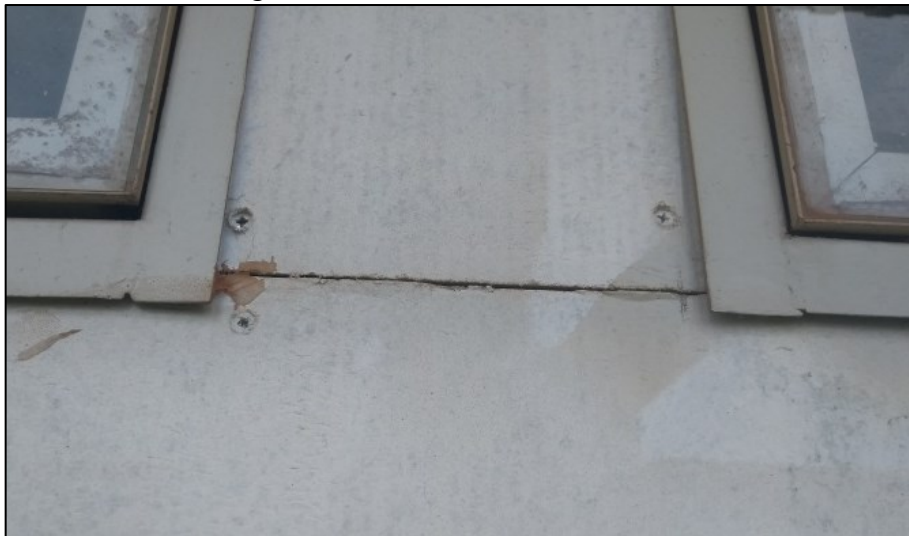
Figura 29 – Junta externa não tratada
