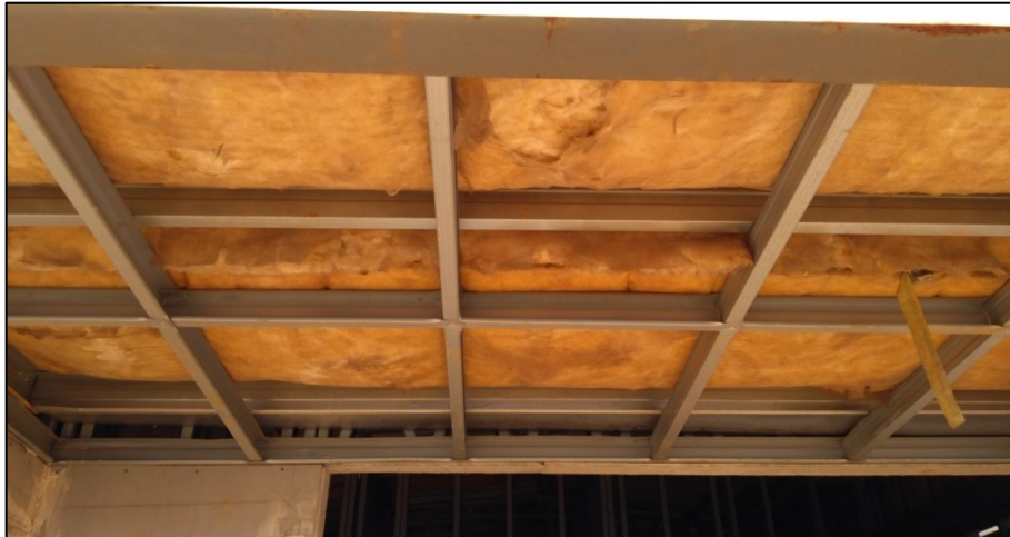
Figura 77 – Manta do deterioração
