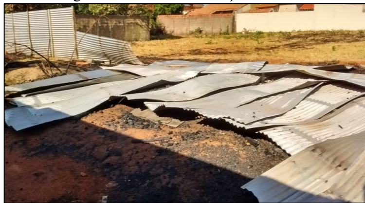
Figura 37 – Placas de vedação tombadas
