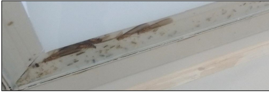
Figura 71 – Acúmulo de insetos em janelas
