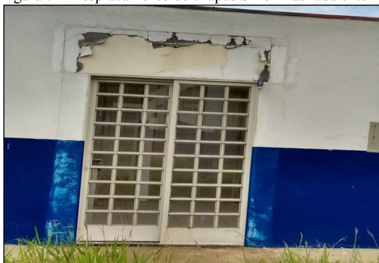
Figura 7 – Deslocamento de chapas ST em fachada externa
