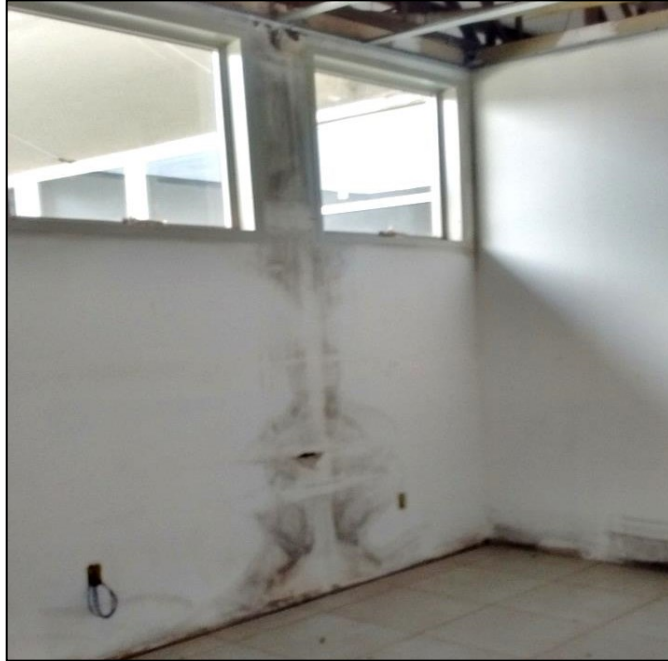
Figura 41 - Infiltrações pelas juntas mal tratadas
