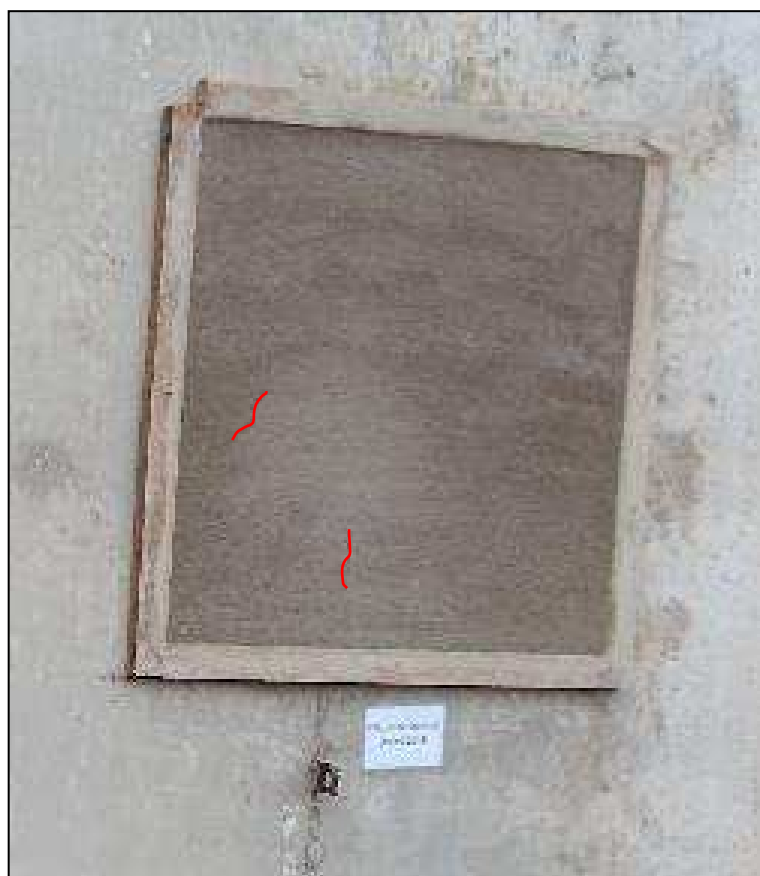
Figura 19 – Fissuras observadas no painel CH de face externa após 1 hora de aplicação da argamassa
