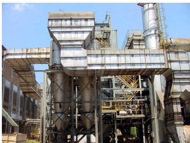
Figura 4 - Foto do sistema de exaustão da caldeira analisada
