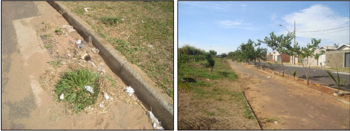
Fotografias 18, 19: Bueiro entupido no Bairro Residencial Pequis, Rua do Tapiti – Bairro Residencial Pequis
