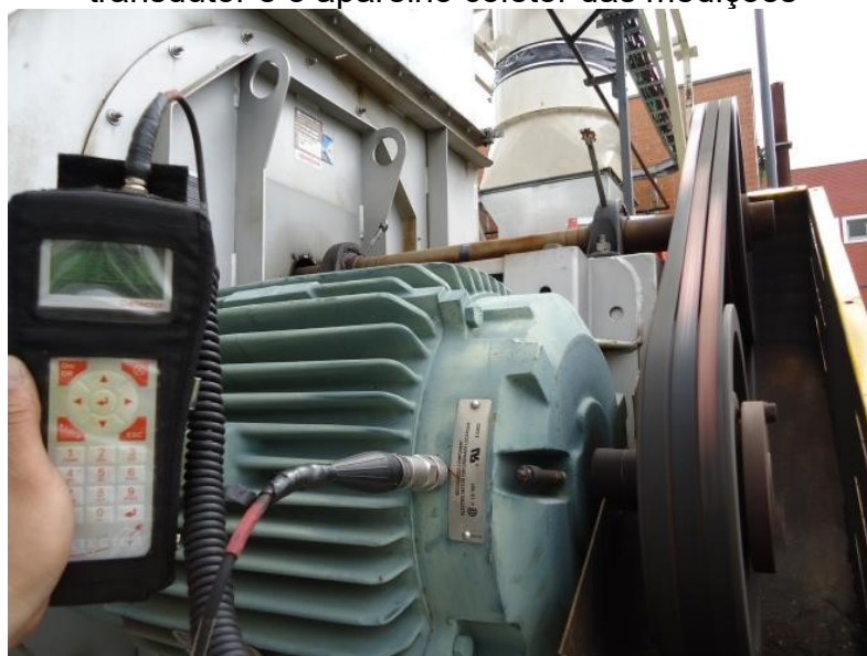
Figura 6 – Técnico realizando análise de vibração em motor, utilizando um transdutor e o aparelho coletor das medições
