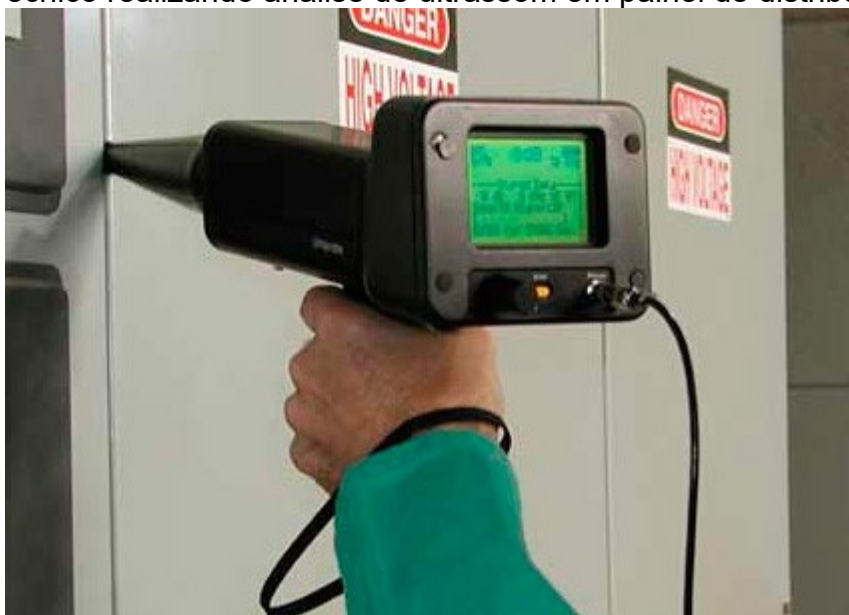
Figura 7 – Técnico realizando análise de ultrassom em painel de distribuição elétrica
