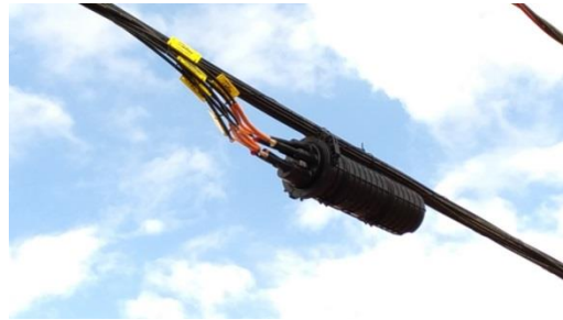
Figura 24 - Caixa de emendas disposta na fiação
