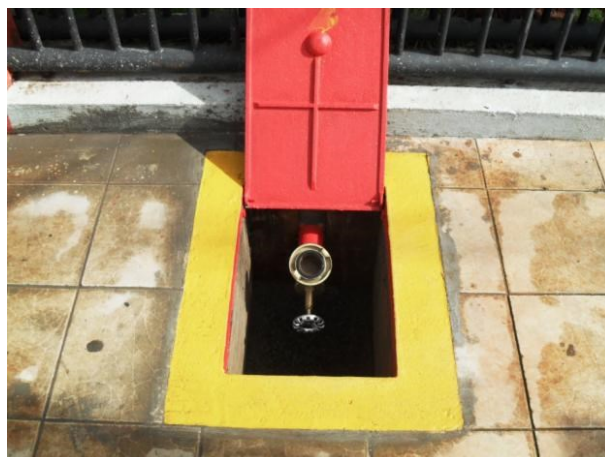
Figura 6 - Hidrante de Recalque.
