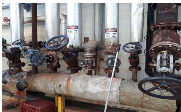
Figura 20 – Barrilete primário da linha de distribuição de vapor.
