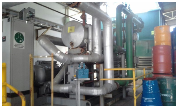
Figura 24 – Chiller encontrado na planta.
