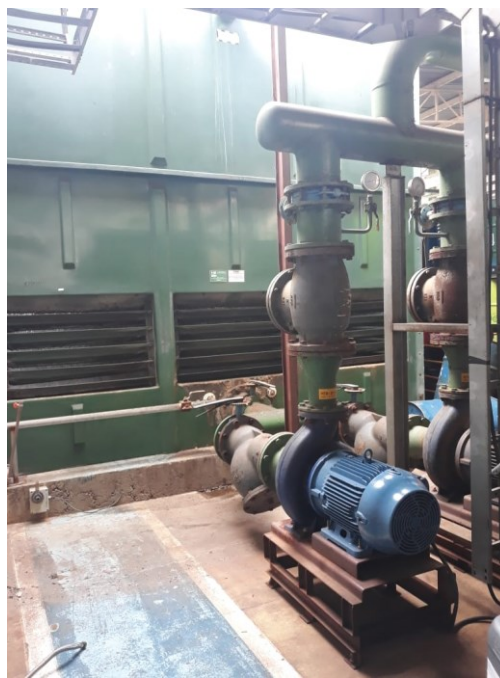
Figura 27 – Torre de resfriamento da fábrica do chiller de maior capacidade.
