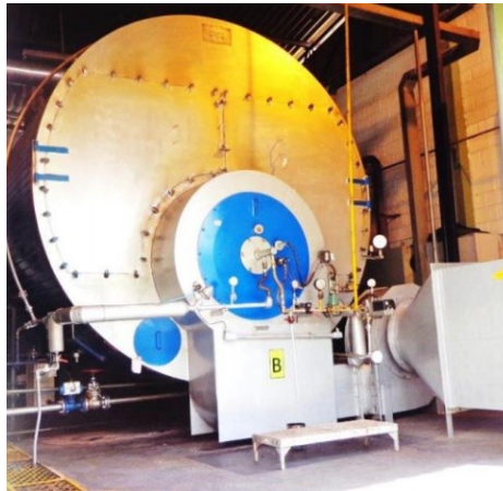
Figura 14 – Caldeira flamotubular encontrada na planta.
