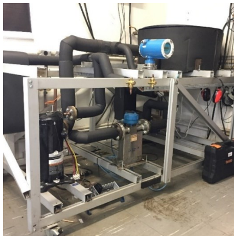
Figura 3.7 Bancada experimental de refrigeração reconstruída para o desenvolvimento deste trabalho.
