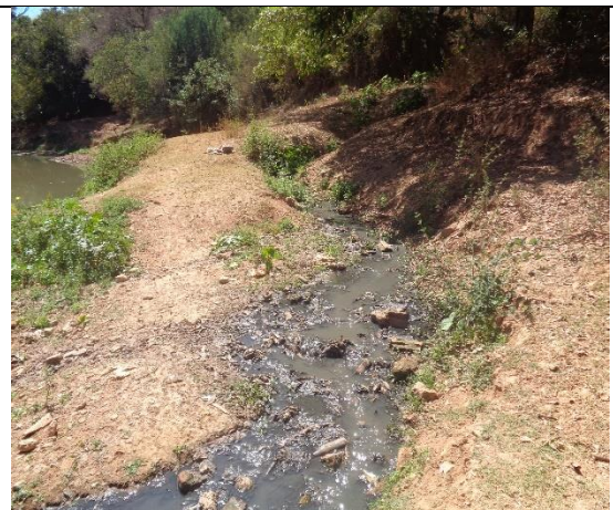
Ponto de lançamento de efluente sem dissipador. Bairro Várzea.
