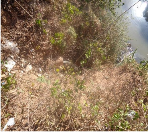
Ponto de lançamento de efluente sem dissipador. Bairro Santa Terezinha.
