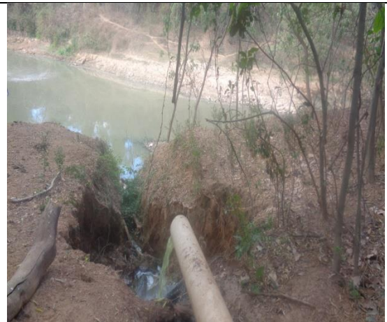
Ponto de lançamento de efluente industrial sem dissipador. Distrito Industrial III.
