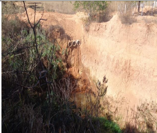
Lançamento de drenagem pluvial sem dissipador. Bairro Sorriso.
