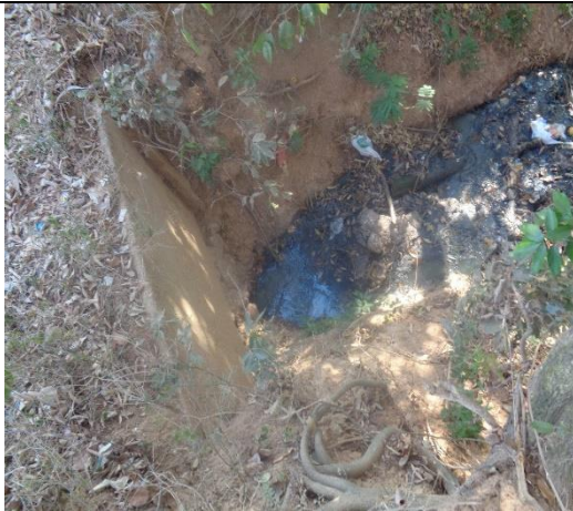
Ponto de lançamento de efluente sem dissipador. Bairro Santa Luzia.
