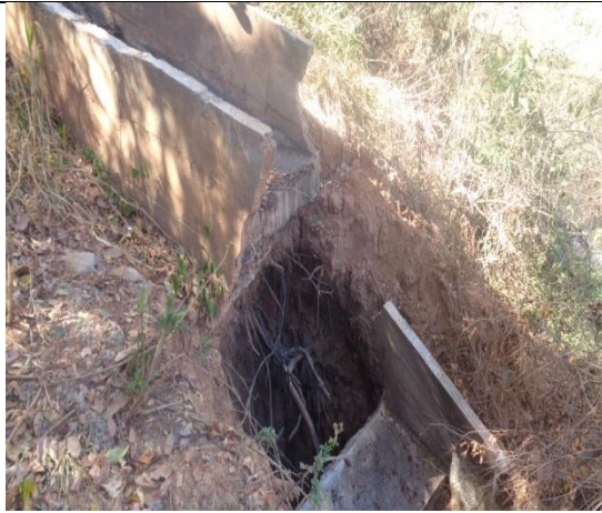
Lançamento de drenagem pluvial com dissipador (sistema de escadaria), porém, sem eficiência. Bairro Quebec.
