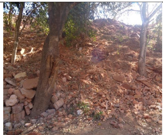
Risco de deslizamento agravado por depósito de entulhos e por falta de cobertura vegetal. Acima existem residências.
