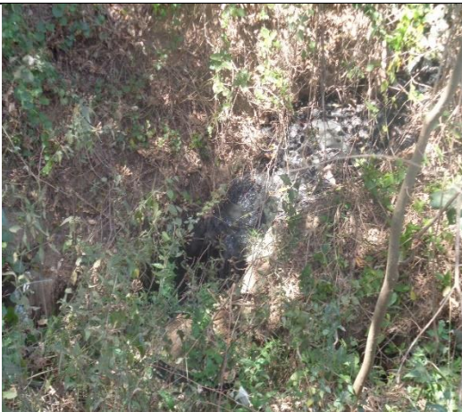
Ponto de lançamento de efluente sem dissipador. Bairro São José Operário.
