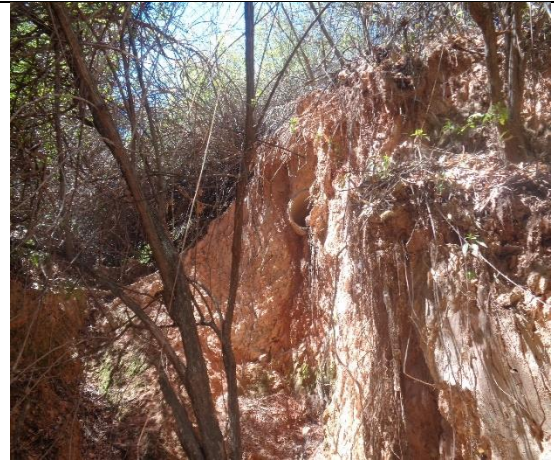
Lançamento de drenagem pluvial sem dissipador. Bairro Santo Antônio.
