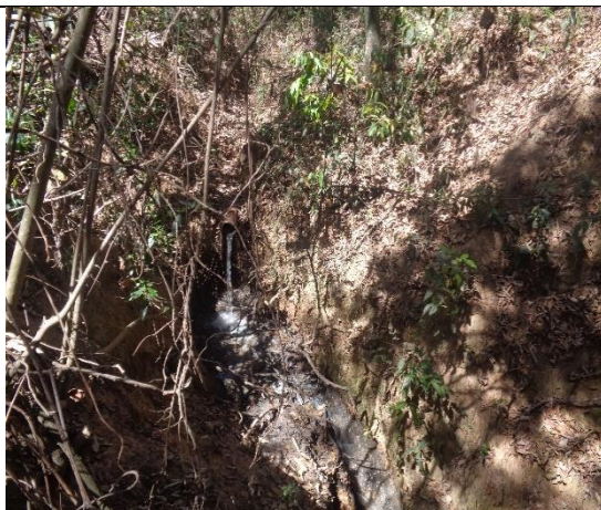
Ponto de lançamento de efluente sem dissipador. Bairro Várzea.
