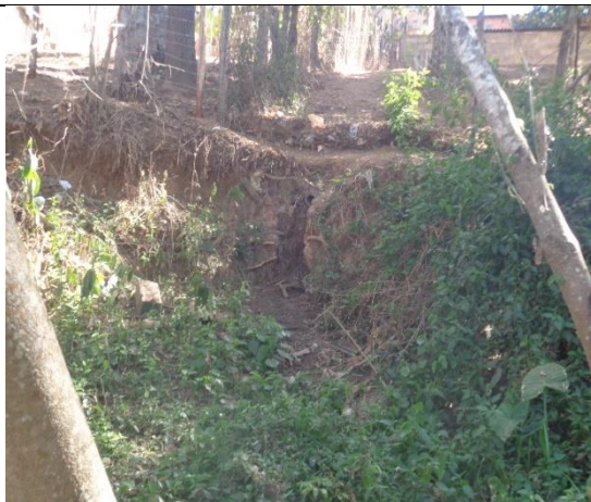
Ponto de lançamento de efluente na APP no Bairro Nossa Senhora Aparecida.
