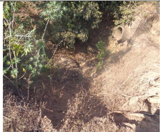
Lançamento de drenagem pluvial sem dissipador. Bairro Brasília.
