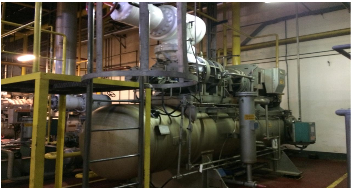
Figura 4 - Unidade compressora de amônia do tipo parafuso.
