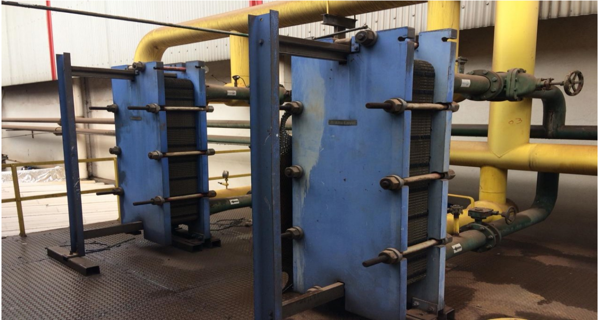
Figura 5 - Trocadores de calor.
