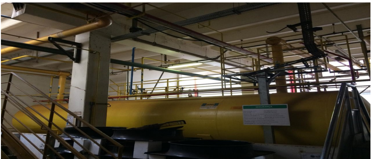
Figura 7 - Reservatório de líquido.
