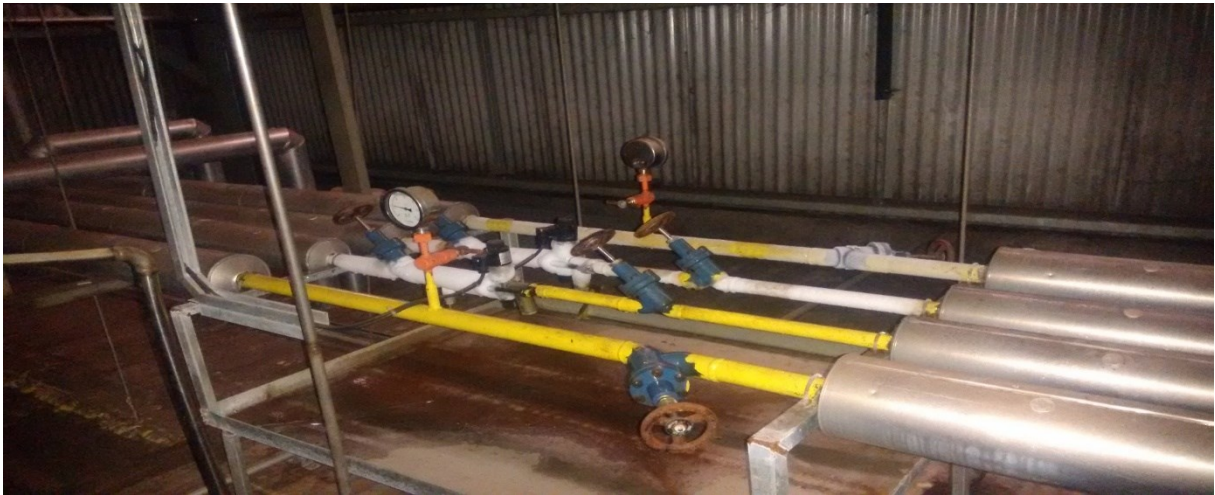
Figura 12 - Painel de válvulas.
