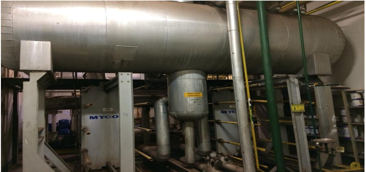
Figura 9 - Sistema de resfriamento da mistura água-propilenoglicol.
