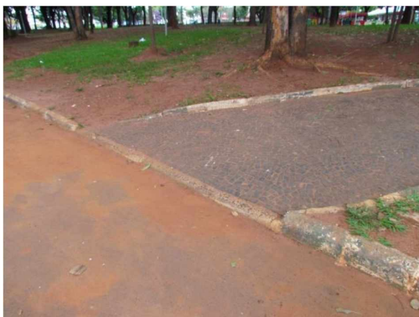
FIGURA 66 - Imagem de acesso fora das normas de acessibilidade
