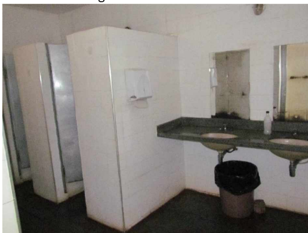
FIGURA 69 – Imagem do sanitário sem acessibilidade
