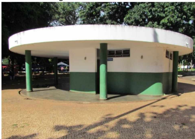
FIGURA 68 - Imagens do bloco de sanitários sem acessibilidade
