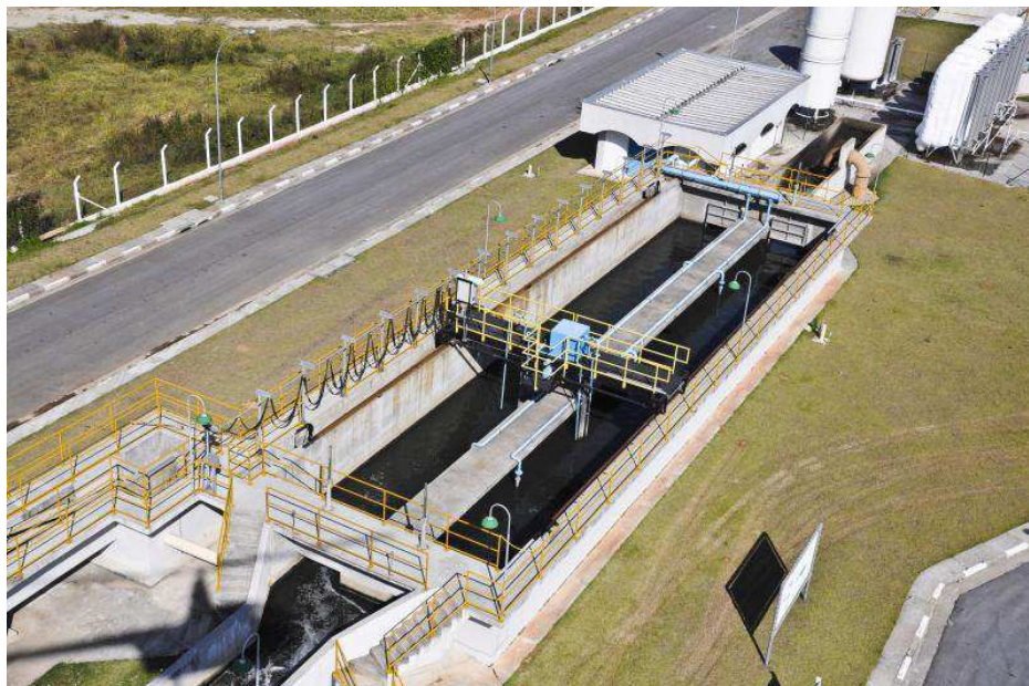
Figura 2.1.3 - Exemplo de tanque de desarenação: Fonte: SIGMA.
