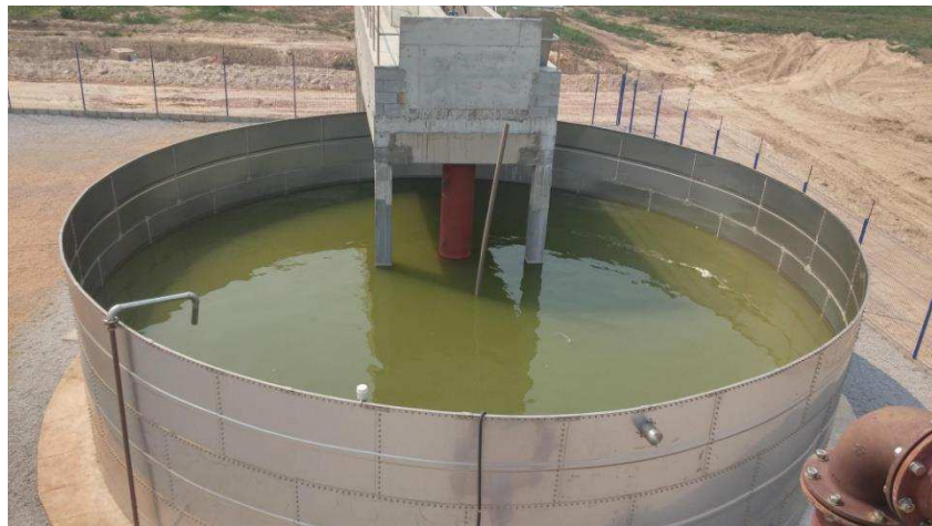
Figura 2.1.5 - Tanque de equalização. Fonte: HIDROSUL.
