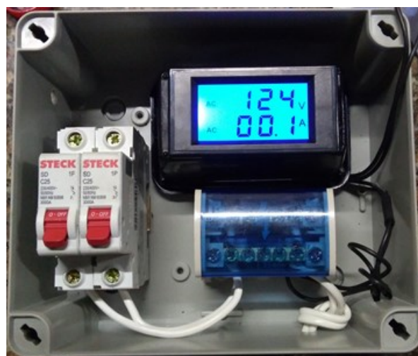
Figura 39 – Painel elétrico em teste
