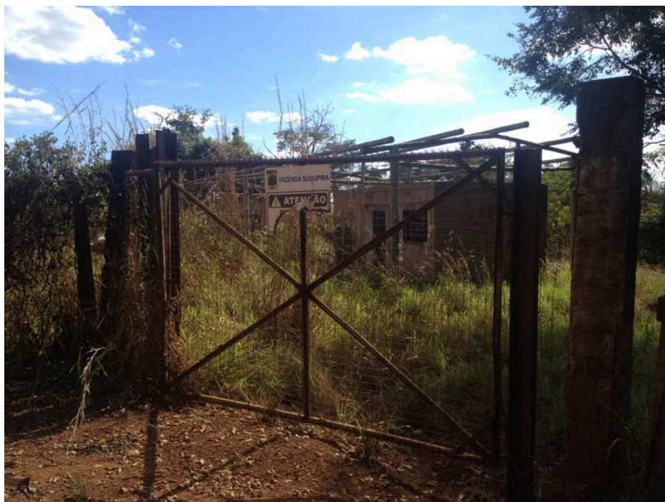
Figura 18 – Estrutura não finalizada, onde seria a portaria do parque.
