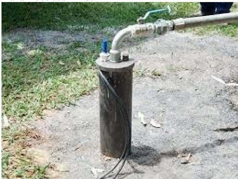
Figura 05 - Poço Tubular no Mart Minas - Avenida Santos Dumont nº 1555 – Bairro: Santa Maria – Uberaba – MG.
