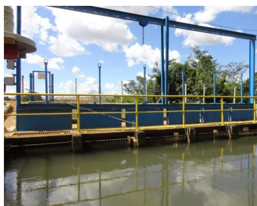
Foto 27 - Gradeamento da água captada.
