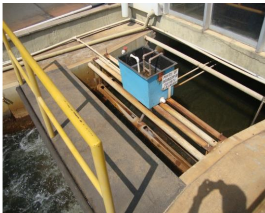
Foto 30 - Ponto de dosagem do Sulfato de Alumínio.
