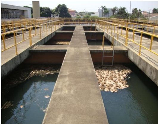
Foto 31- Tanque de Floculação.
