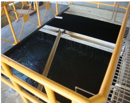
Foto 29 - Ponto de dosagem da Cal Hidratada.
