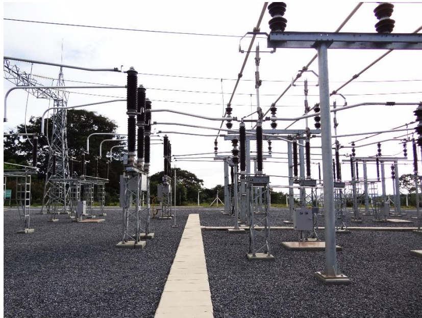
Figura 3 - Fotografia de um arranjo de barra simples da subestação de São Gotardo.
