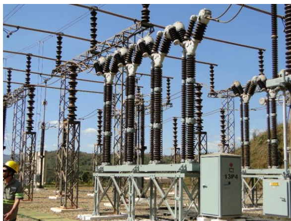
Figura 23 -Fotografia de um disjuntor de 230kV da subestação de Taquaril
