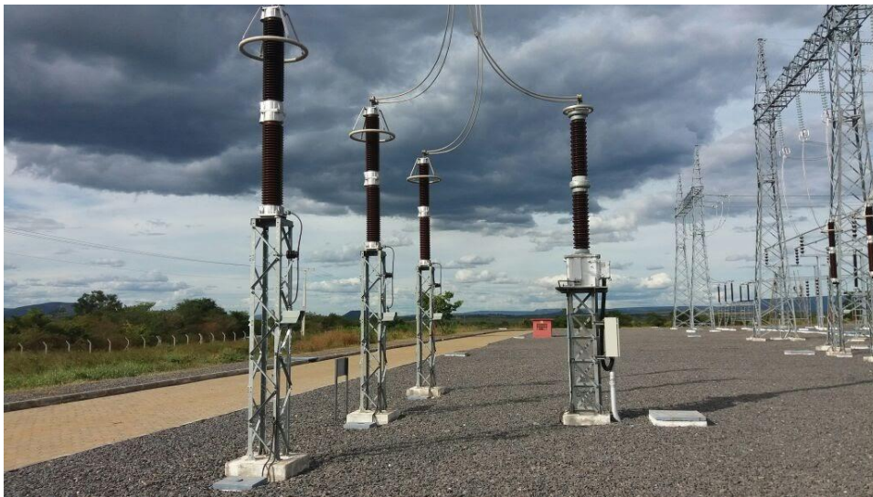
Figura 22 - Foto para modelagem de equipamentos - Subestação de Araçuaí
