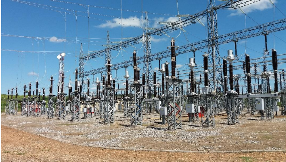
Figura 2 - Subestação de baguari, tensão de 138kV
