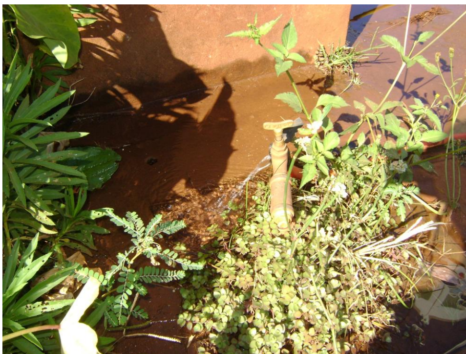
FIGURA 22 - Torneira área externa do CAIC – 17/05/11.
