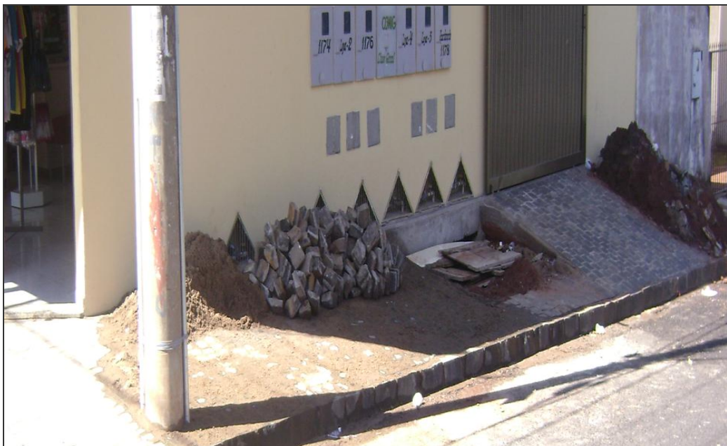
Foto 12 - Uberlândia (MG): calçada com declividade acentuada e com material de construção impedindo a passagem das pessoas (2009)
