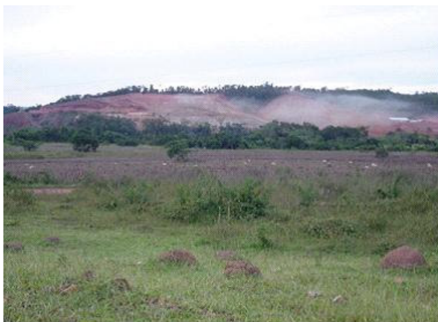
Foto 56 - Fumaça se espalhando após explosão no local de construção da UHE Capim Branco II. Autora: LEMOS, J. C. Maio, 2004.
