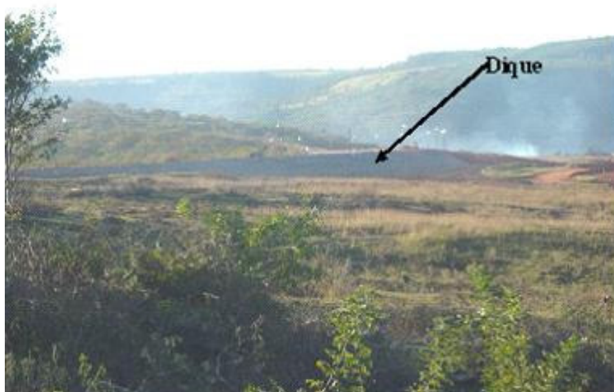
Foto 78 - Construção do dique na área da UHE Capim Branco I. Autora: LEMOS, J. C. Julho, 2005.
