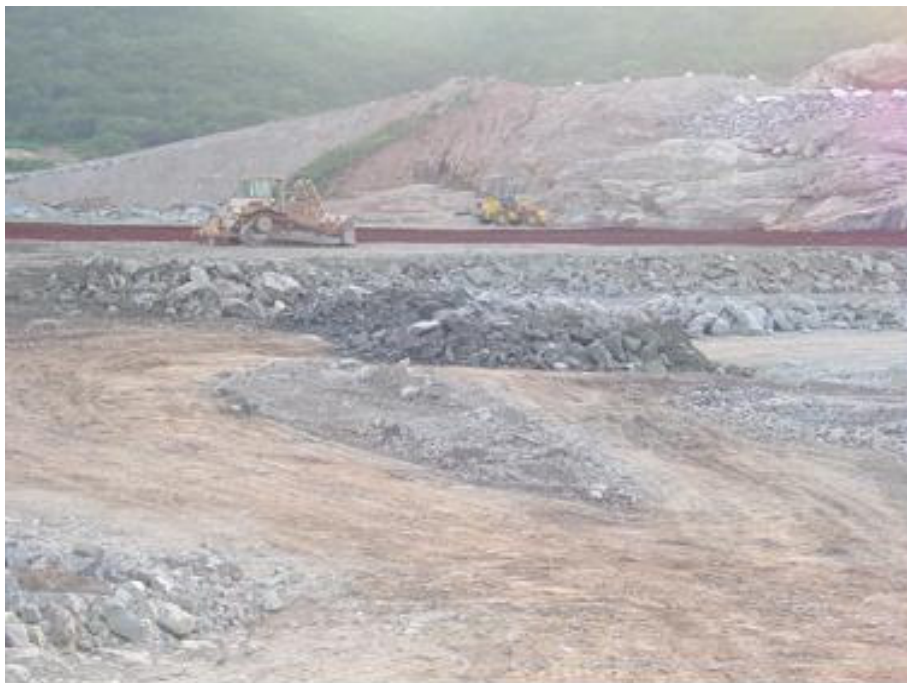
Foto 77 - Continuação da construção da barragem da UHE Capim Branco I. Autora: LEMOS, J. C. Abril, 2005.
