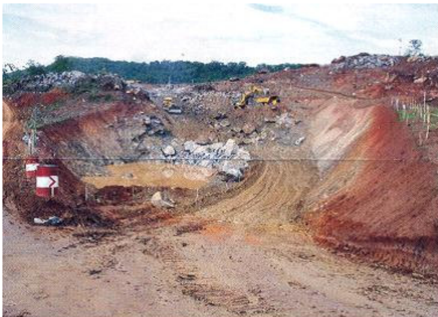
Foto 52 - Escavação para a construção do Túnel para o desvio da água em 28 de novembro de 2003.
