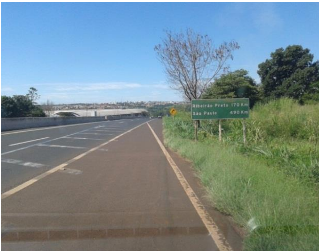
Figura 3.19: Foto: Sinalização de pavimento antiga e nova causando confusão.
